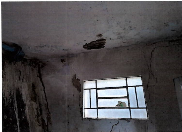
Foto 6: Visto do interior do abrigo do barrilete das tubulações de saída e descarga. Destaca-se a presença de rachaduras, e vidro quebrado e deterioração da laje.
