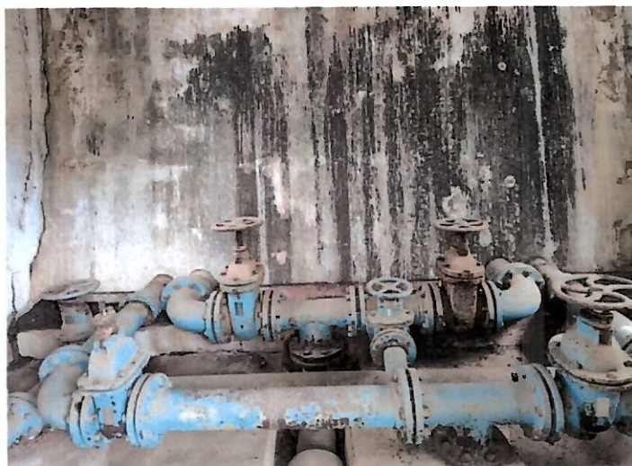
Foto 7: Vista do barrilete das tubulações de saída e descarga. Destaca-se a presença de áreas com corrosão e pintura deteriorada.
