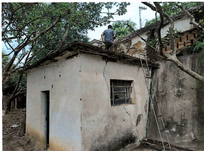
Foto 5: Visto do abrigo do barrilete das tubulações de saída e descarga. Destaca-se a presença de rachaduras e vidro quebrado.
