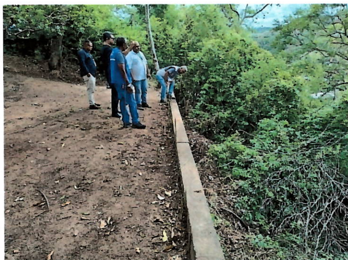
Foto 14: Vista de área nos fundos do terreno da unidade. Nota-se ausência de guarda-corpo ou muro de proteção.
