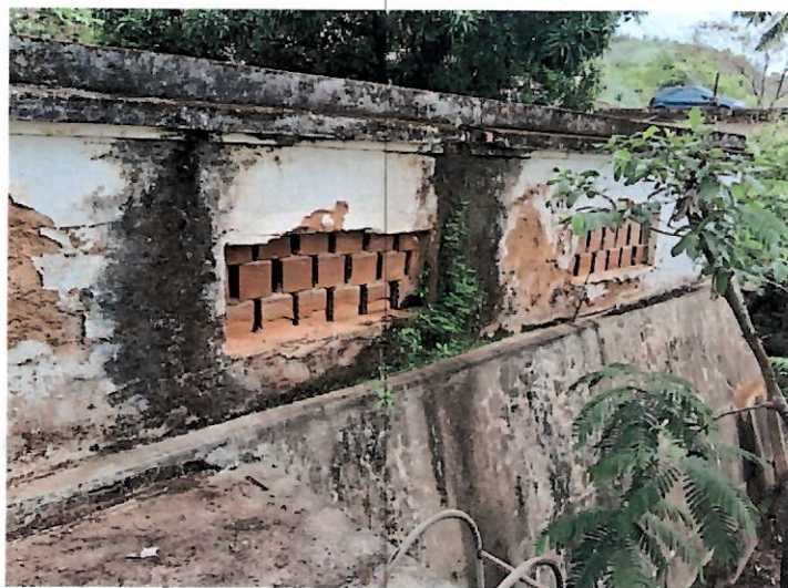
Foto 10: Vista dos dispositivos de ventilação. Destaca-se a ausência de telas e o acabamento inadequado.
