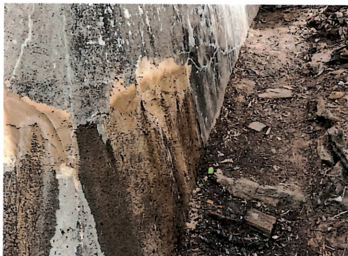
Foto 3: Detalhe de trecho com vazamento aparente na lateral do reservatório.
