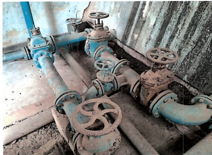
Foto 8: Barrilete das tubulações de saída e descarga. Destaca-se a presença de áreas com corrosão, pintura deteriorada e resíduos.
