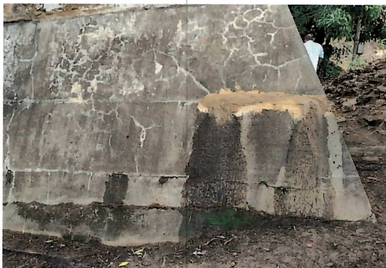
Foto 4: Vista da frente do reservatório com área com vazamento aparente.
