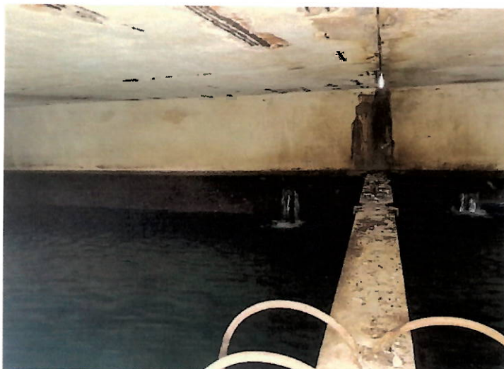
Foto 11: Vista do interior do reservatório. Destaca-se a presença de fissura na laje, que está permitindo a infiltração de água pluvial, e deterioração da armadura da laje.
