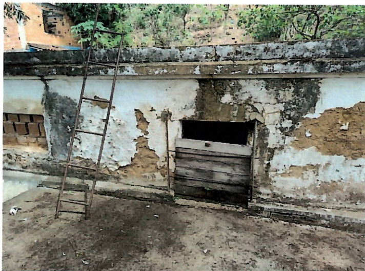
Foto 9: Vista da janela de inspeção. Destaca-se a vedação inadequada, a tampa deteriorada, a escada sem condições de uso seguro e a necessidade de manutenção da alvenaria.
