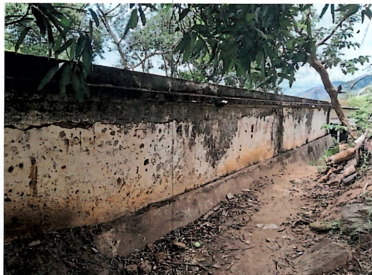
Foto 2: Vista da parede dos fundos do reservatório. Nota-se rachaduras, deterioração do revestimento e resíduos.
