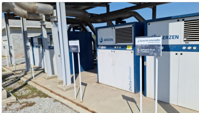
Foto 14 – Sopradores de ar.
