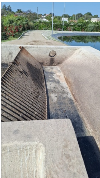
Foto 3 – Tanque de descarregamento de carros limpa-fossa, com gradeamento grosso.
