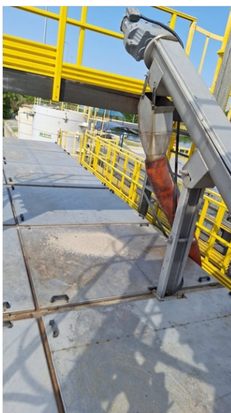
Foto 9 – Sistema de bomba parafuso para remoção de areia do desarenador
