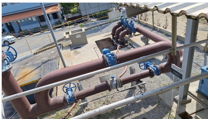
Foto 6 – Elevatória de esgoto bruto.
