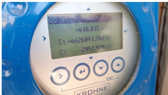
Foto 11 – Medidor de vazão; 618,835 \text{ m}^3/\text{h} = 171,9 \text{ l/s} .
