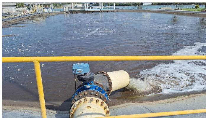
Foto 13 – Tanque de aeração, com fluxo de vazão, medidor eletrônico, tubulações dos difusores (em tela)
