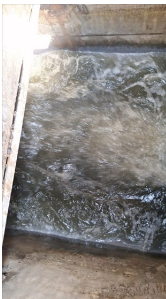
Foto 7 – Esgoto bruto recalcado.
