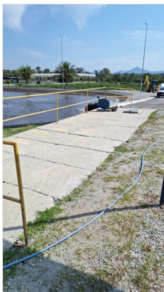
Foto 5 – Caixa de areia com visita para retirada de areia ( dos carros limpa-fossa)
