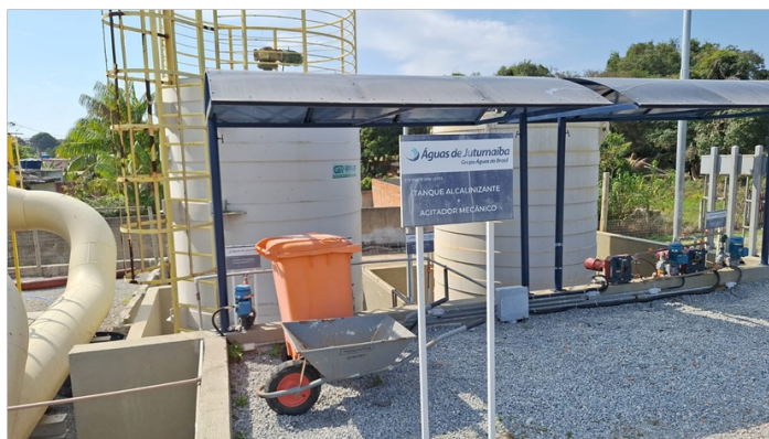
Foto 10 -Depósito, preparação e dosagem do coagulante PAC (policloreto de alumínio)
