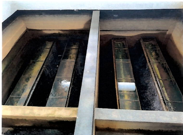
Foto 13: Vista superior dos filtros.
