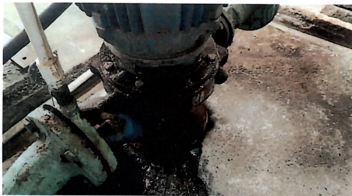
Foto 29: Vazamento no conjunto motobomba da elevatória que abastece os bairros Centro, Subúrbio e adjacências.
