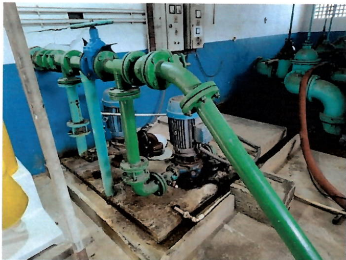
Foto 28: Conjuntos motobombas da elevatória que abastece os bairros Centro, Subúrbio e adjacências. Nota-se vedação improvisada do poço de sucção, parede quebrada da calha de drenagem e corrosão na tubulação de recalque.
