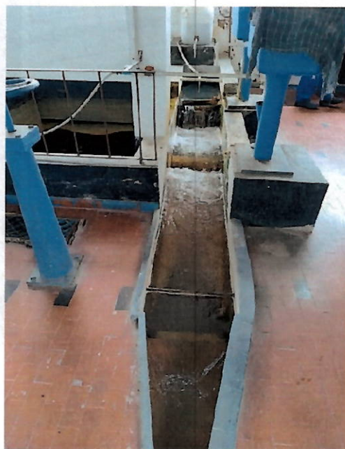
Foto 8: Entrada da água bruta na estação (ao fundo) e dispositivo de coagulação.
