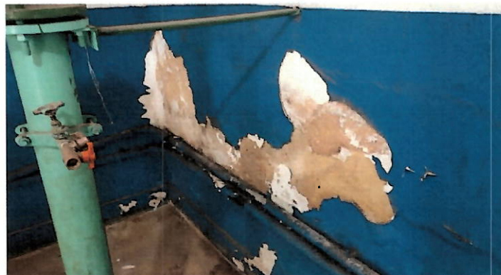
Foto 27: Parede deteriorada próxima ao conjunto motobomba da elevatória que abastece o bairro São João com fiação exposta.
