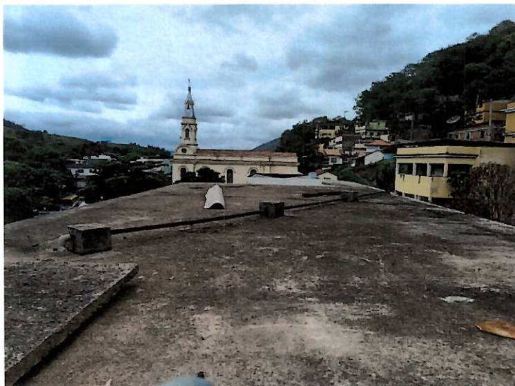
Foto 48: Vista superior do reservatório do sistema de retrolavagem dos filtros. Nota-se ausência de guarda-corpo.
