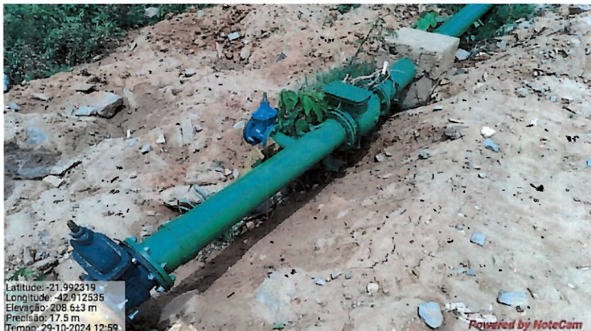
Foto 2: Adutora metálica de captação dotada de registro e válvula de retenção.
