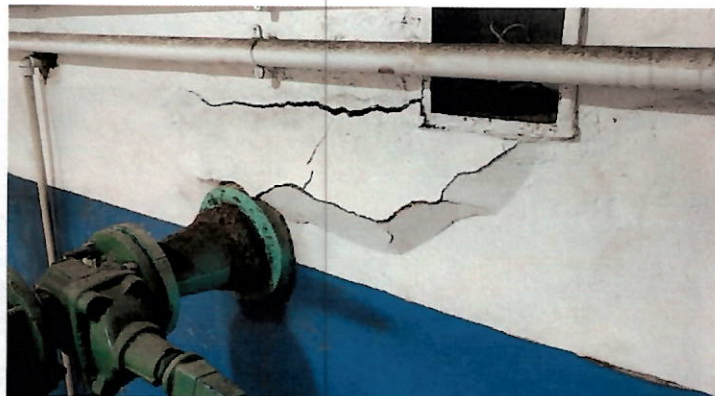
Foto 30: Parede com deterioração avançada próxima a tubulação de recalque do conjunto motobomba da elevatória que abastece os bairros Centro, Subúrbio e adjacências. Indício de necessidade de alívio do impacto e da vibração do sistema de recalque transmitidos para a parede.
