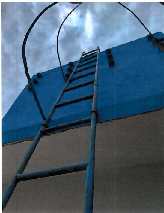
Foto 47: Escada fixa tipo marinheiro com proteção em desacordo com a NR-12.
