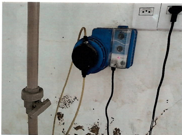
Foto 37: Bomba dosadora utilizada na aplicação do sulfato de alumínio.
