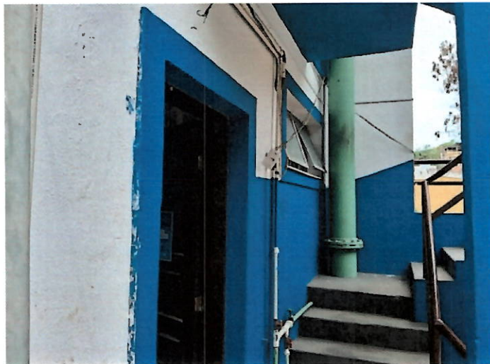
Foto 42: Vista da tubulação de retrolavagem dos filtros.
