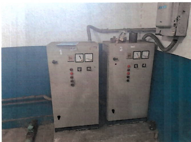
Foto 24: Painéis elétricos dos conjuntos motobombas da elevatória que abastece o bairro São João. Há necessidade de modernização e organização.
