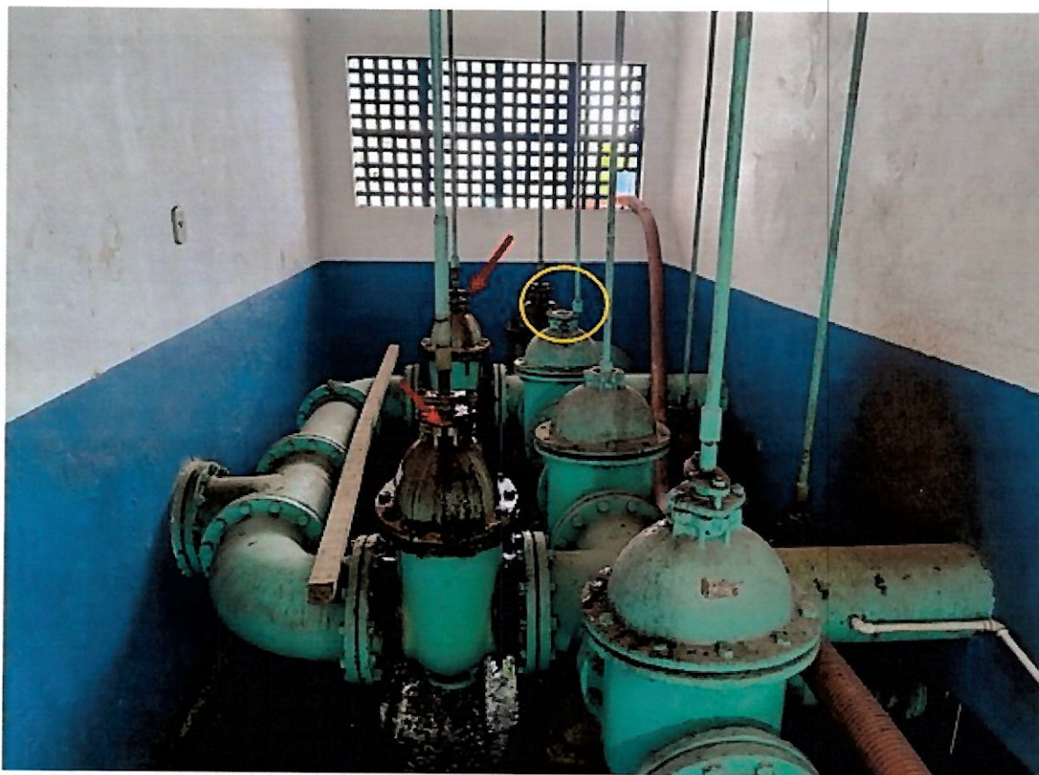
Foto 21: Vazamento nos registros de bloqueio da água de retrolavagem e haste de um dos registros do barrilete dos filtros solta do corpo, estando esse registro sem condição de uso.
