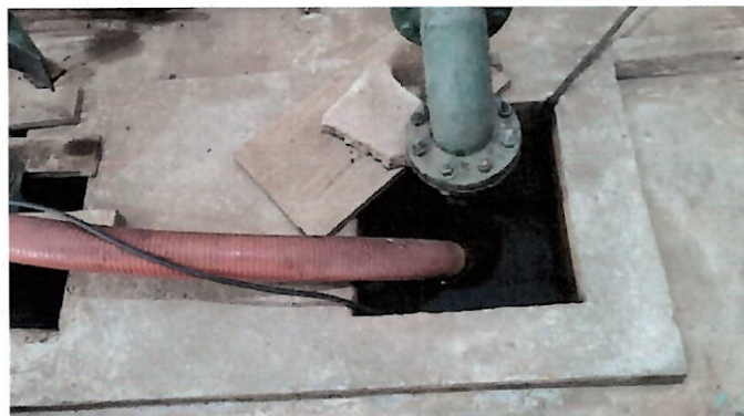
Foto 25: Poço de sucção da elevatória que abastece o bairro São João. Nota-se ausência de tampa na visita e apoio improvisado da tubulação de sucção.
