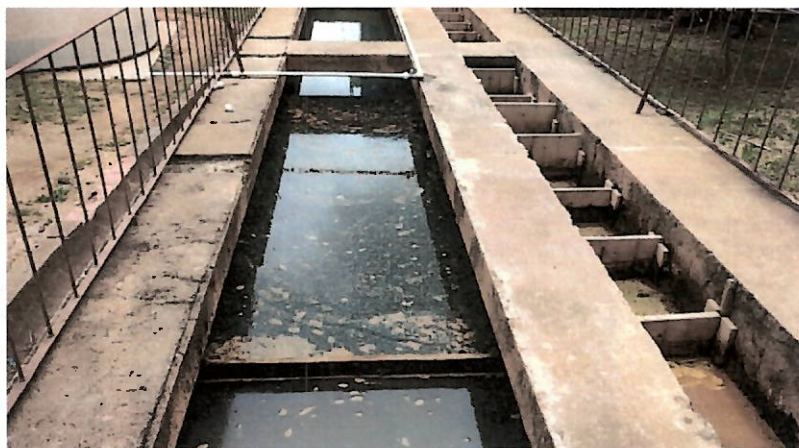
Foto 10: Detalhe dos tanques de floculação (à direita) e decantação (à esquerda). Nota-se depressão em trecho do piso.
