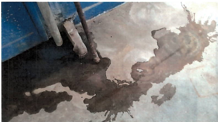
Foto 31: Poça d'água devido a vazamento na Casa de Bombas.
