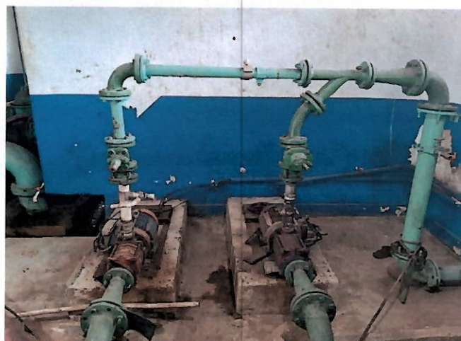
Foto 23: Conjuntos motobombas da elevatória que abastece o bairro São João.
