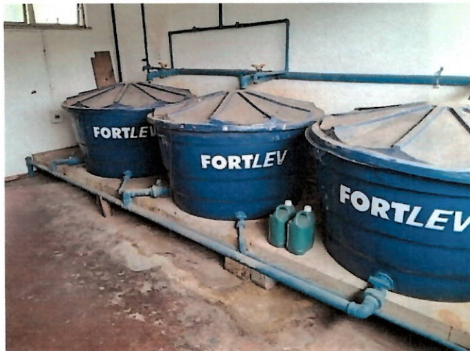
Foto 40: Reservatórios elevados de sulfato de alumínio (ausência de bacia de contenção).
