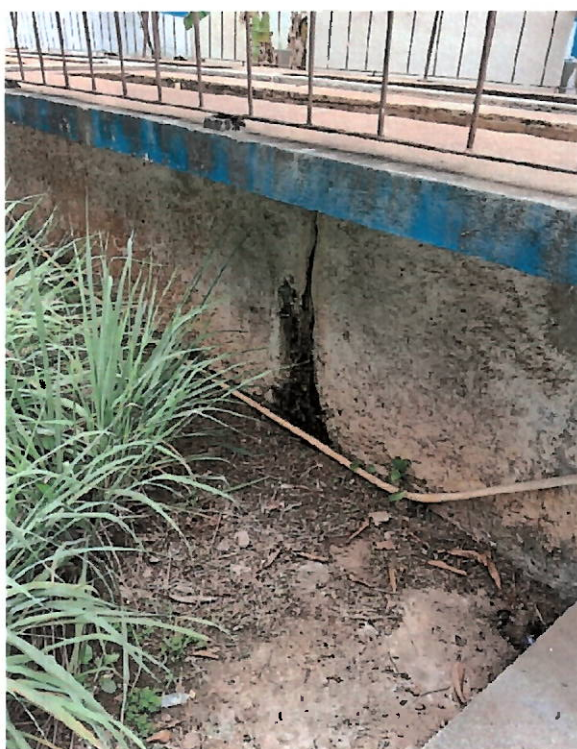
Foto 11: Lateral externa do tanque de floculação, nota-se área com infiltração.
