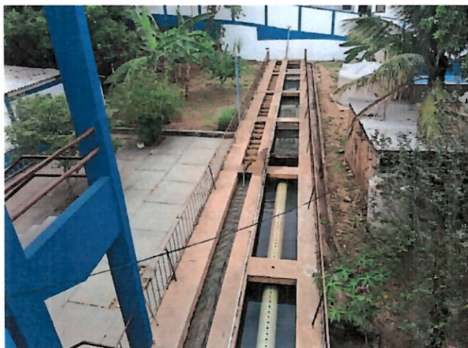
Foto 9: Vista superior dos tanques de floculação (à esquerda) e decantação (à direita).
