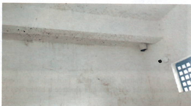
Foto 22: Vista de uma das paredes externas do filtro com marcas de umidade.
