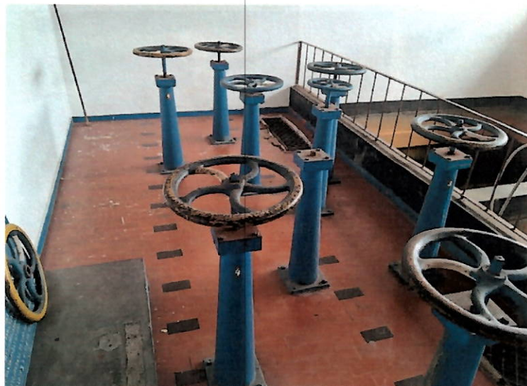
Foto 14: Registros de controle da entrada de água nos filtros e do sistema de retrolavagem.
