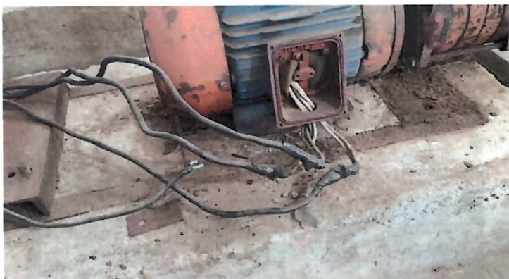
Foto 26: Conjunto motobomba da elevatória que abastece o bairro São João com fiação exposta. Nota-se ausência de tampa na visita e apoio improvisado da tubulação de sucção.
