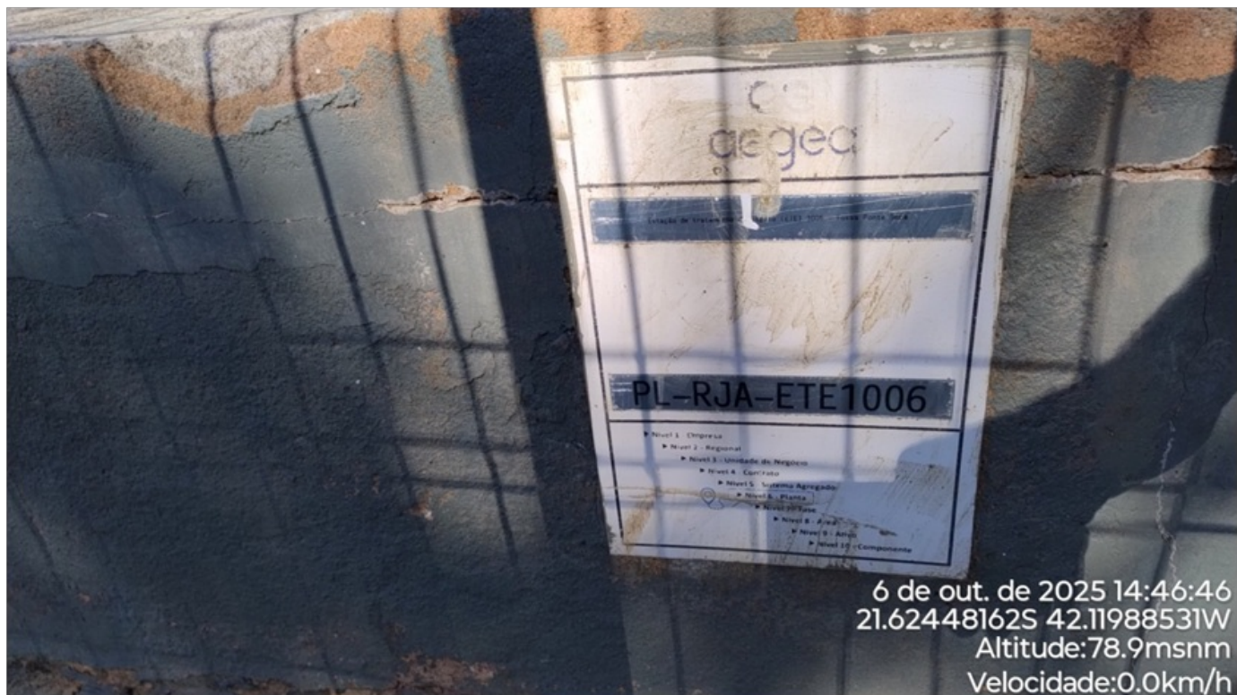
Foto 02 – Placa interna de identificação do bem reversível.
