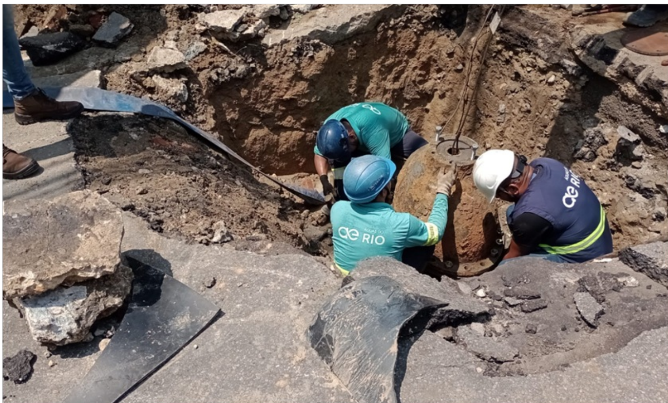
Foto 13 – Bomba de esgotamento
