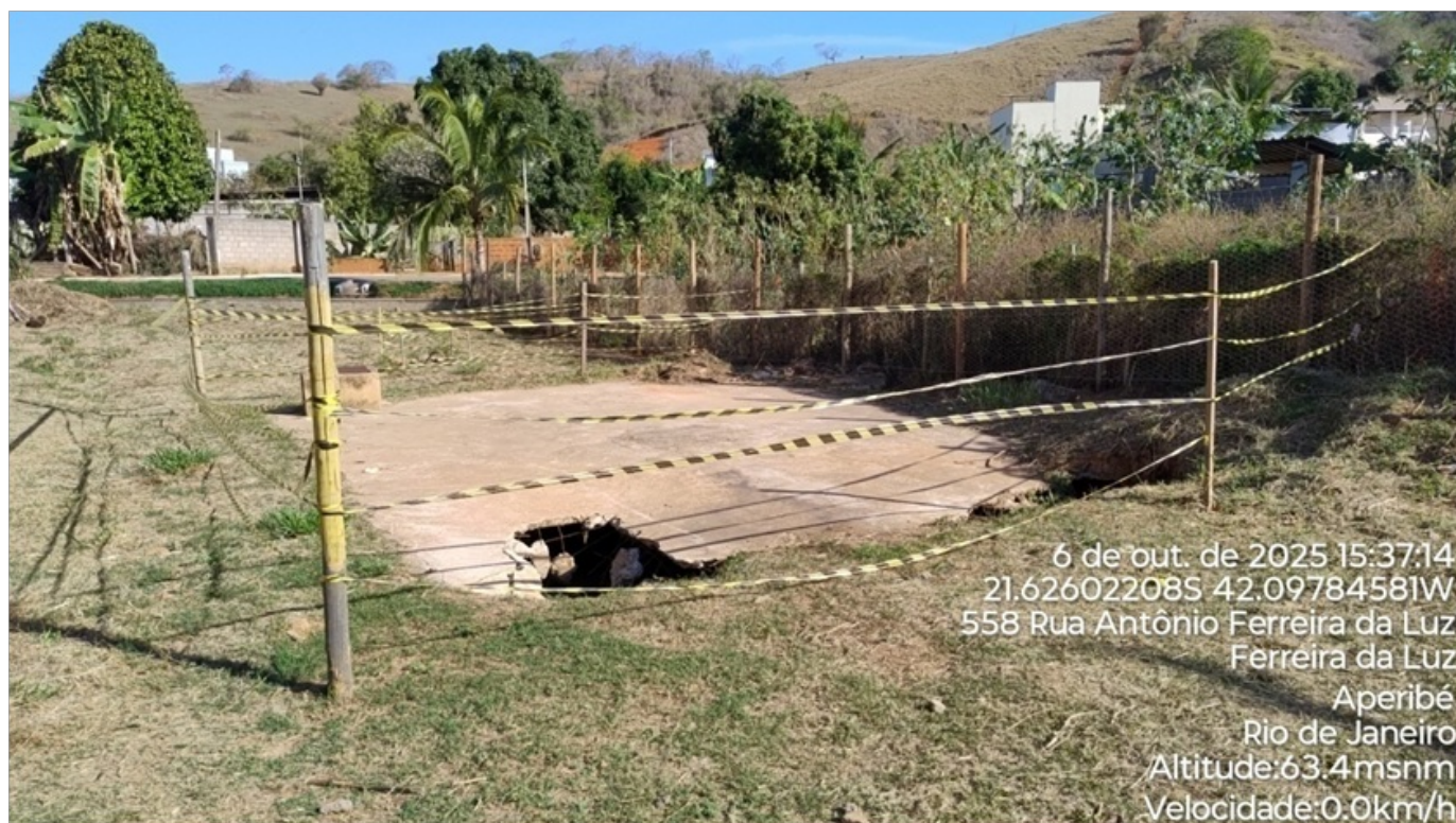
Foto 02 – Laje de cobertura da fossa danificada.
