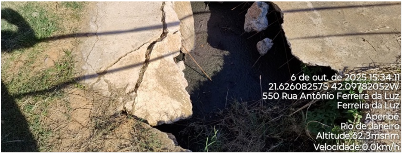
Foto 04 – Laje de cobertura da fossa danificada.
