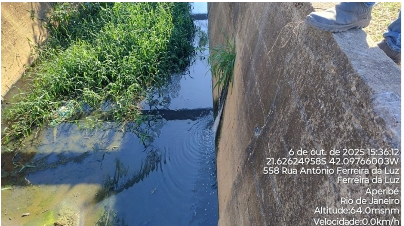
Foto 05 – Ponto de lançamento do efluente pós tratamento.
