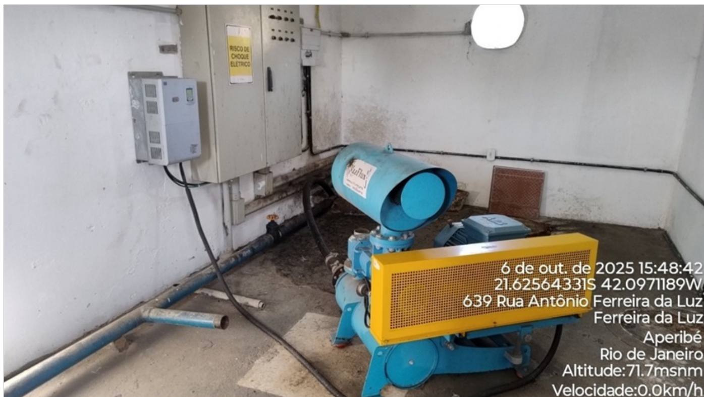
Foto 14 - Compressor de ar para aeração do biofiltro.
