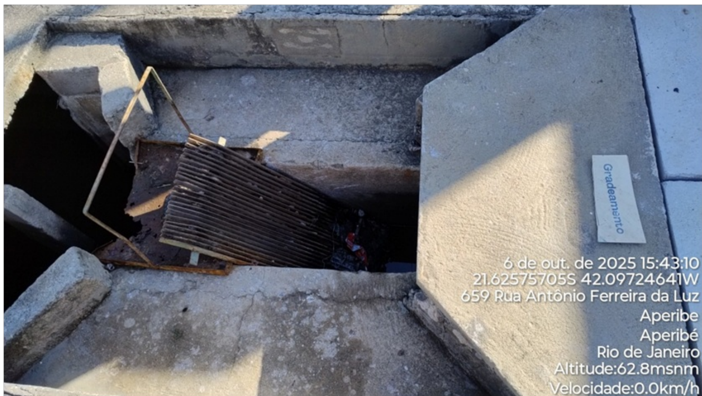
Foto 05 – Gradeamento na chegada do efluente.
