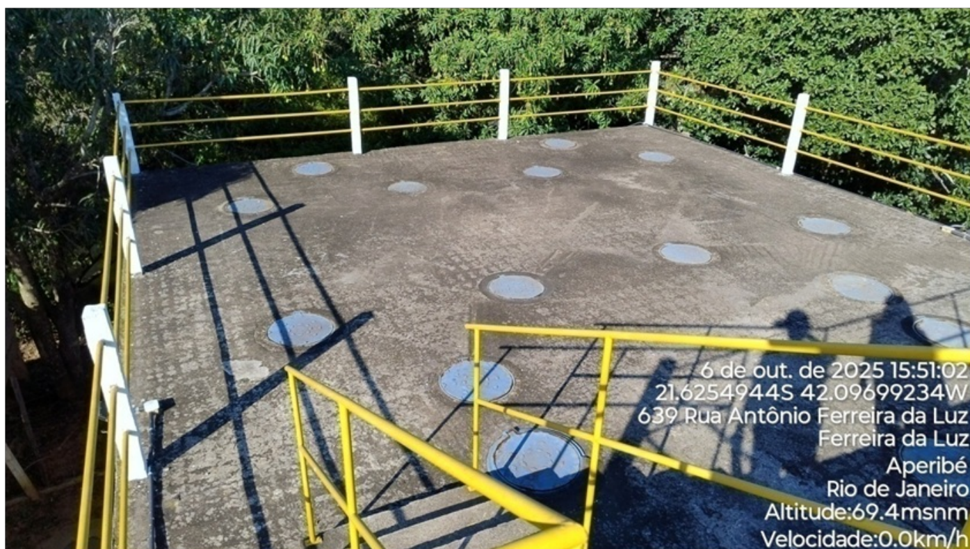
Foto 13 – Filtro aerado submerso e decantador secundário do Módulo 2.
