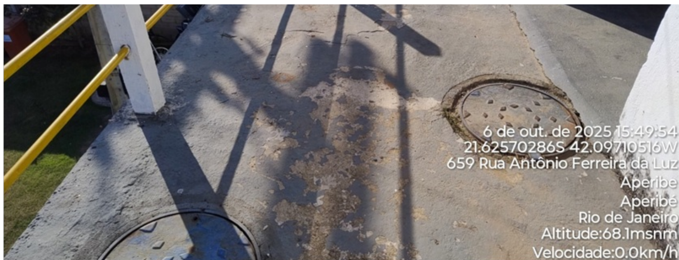
Foto 12 - Decantador Secundaário do Módulo 1.
