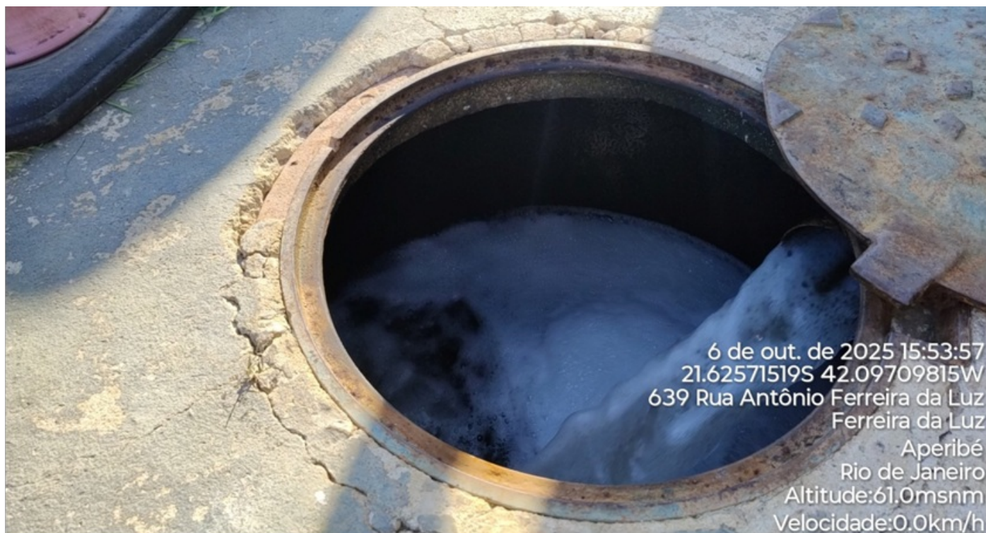
Foto 16 - Lançamento do efluente tratado.
