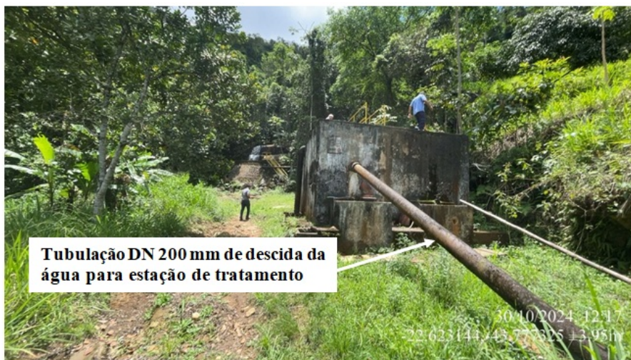
Foto 06 – Visão Geral da Captação
