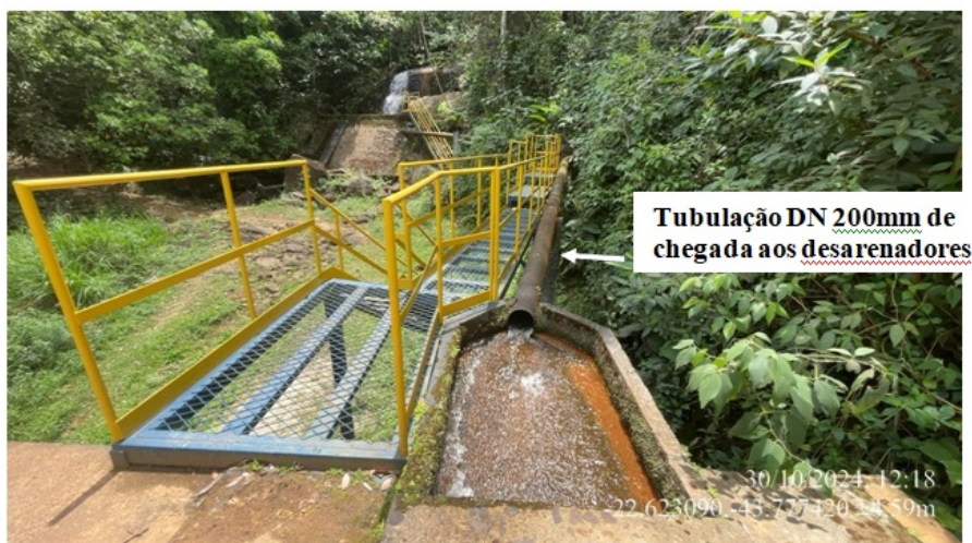
Foto 03 – Tubulação de chegada aos desarenadores
