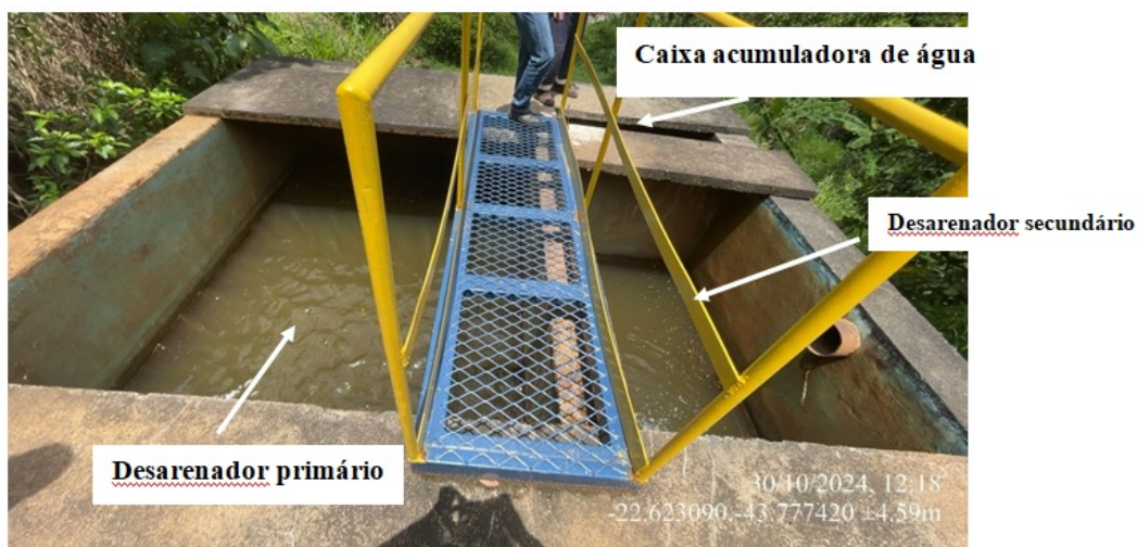
Foto 04 – Desarenadores e caixa acumuladora
