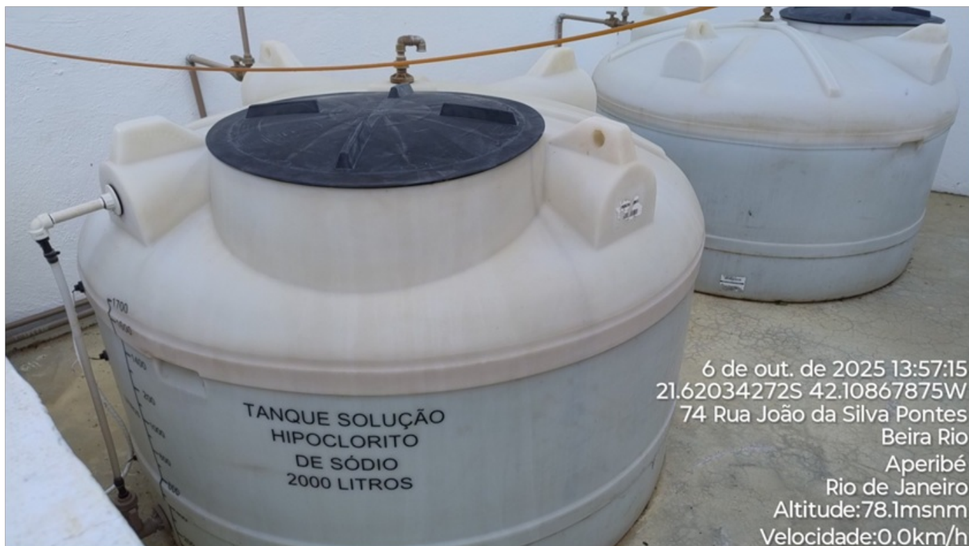
Foto 15 - Tanques de armazenamento de Hipoclorito de sódio.
