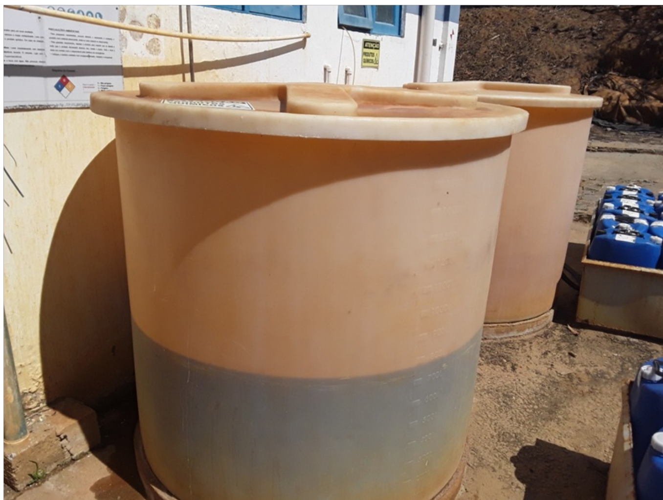
Foto 13 - Armazenamento do Sulfato de alumínio.
