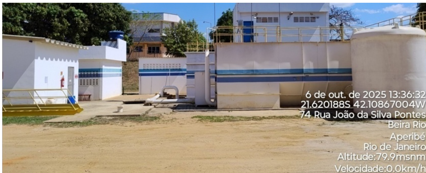
Foto 03 – Vista geral dos módulos de tratamento.
