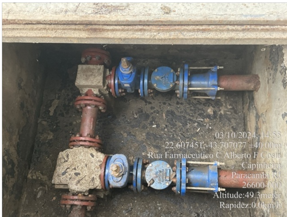
Foto 03 – Barrilete de recalque
