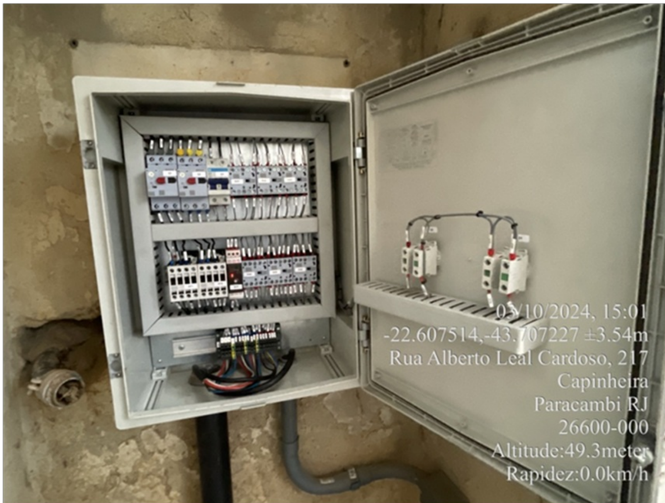
Foto 06 – Parte interna do quadro de comando
