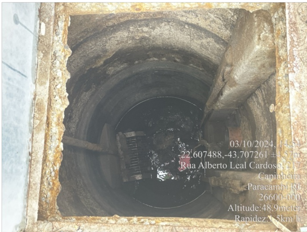
Foto 04 – Poço de sucção das bombas submersas e gradeamento
