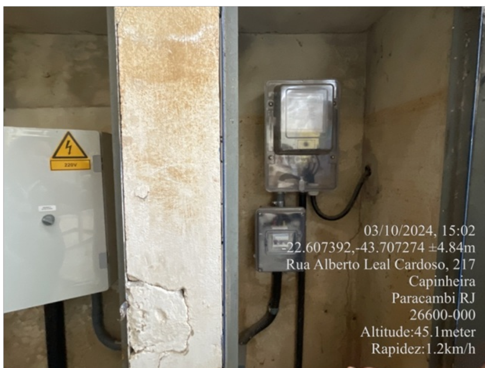
Foto 05 – Quadros de comando elétrico
