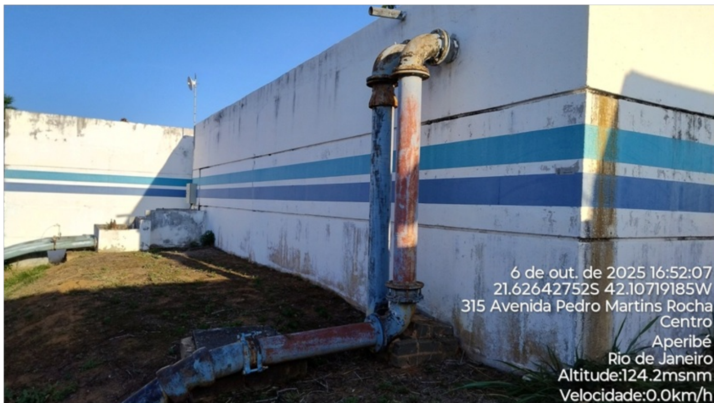
Foto 07 - Tubulação de entrada do reservatório.
