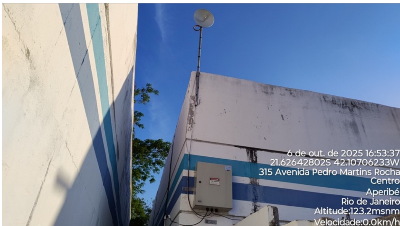
Foto 09 - Equipamentos de telemetria do reservatório.
