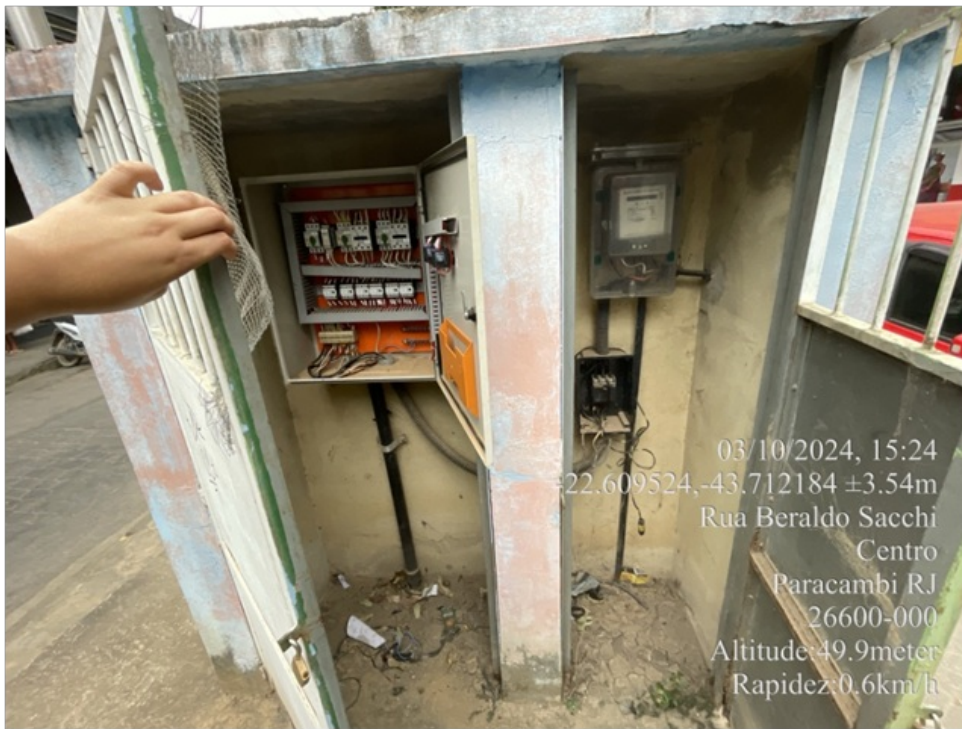
Foto 05 – Parte interna do quadro de comando
