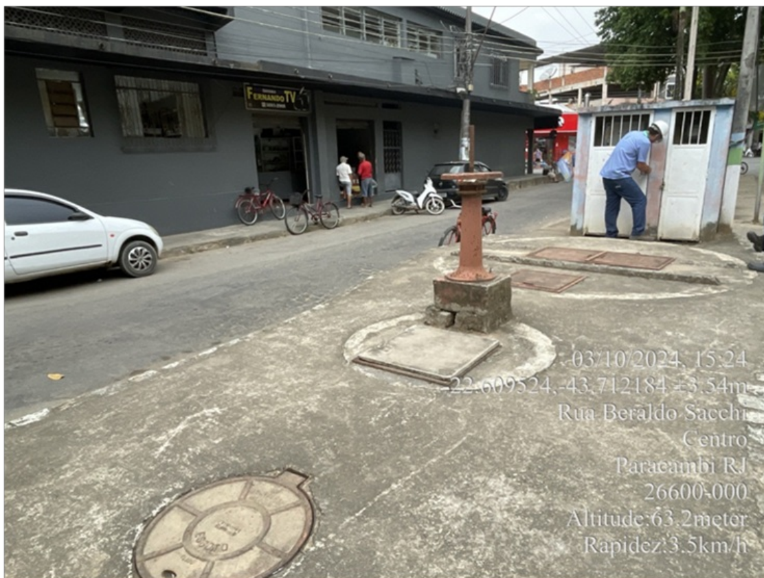
Foto 01 - Vista geral elevatória
