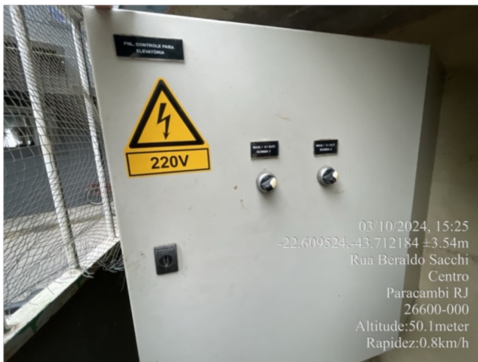
Foto 04 – Quadros de comando elétrico
