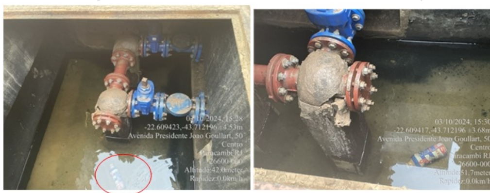
Foto 02 – Barrilete de recalque
