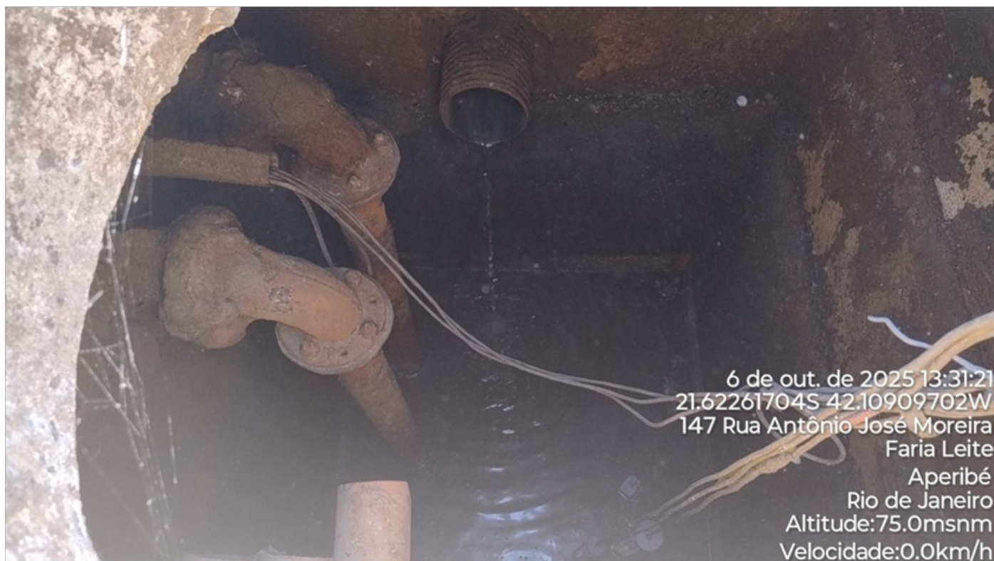
Foto 02 – Poço da motobomba submersível de recalque.
