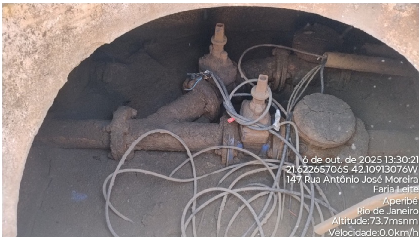
Foto 03 – Tubulação de recalque, válvulas de retenção e fechamento.
