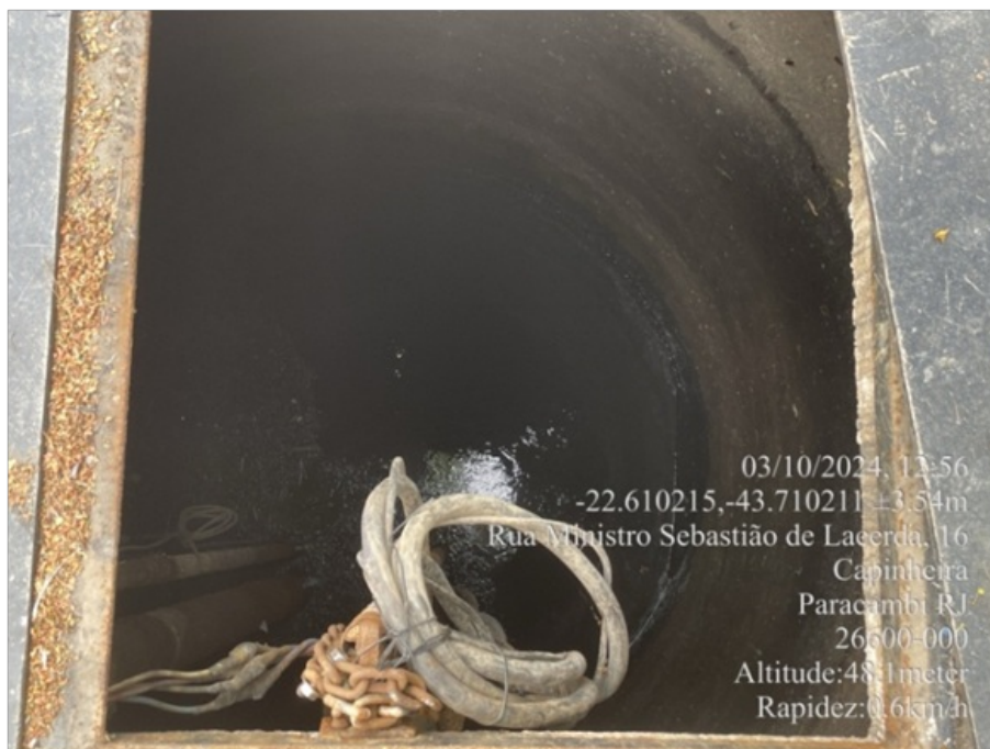
Foto 03 – Poço de sucção das bombas submersas
