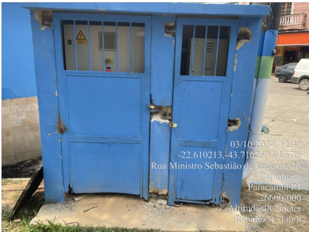
Foto 04 – Quadros de comando elétrico
