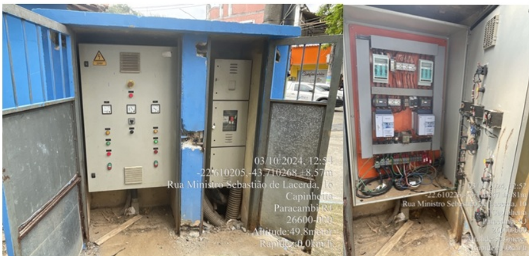
Foto 05 – Parte interna do quadro de comando
