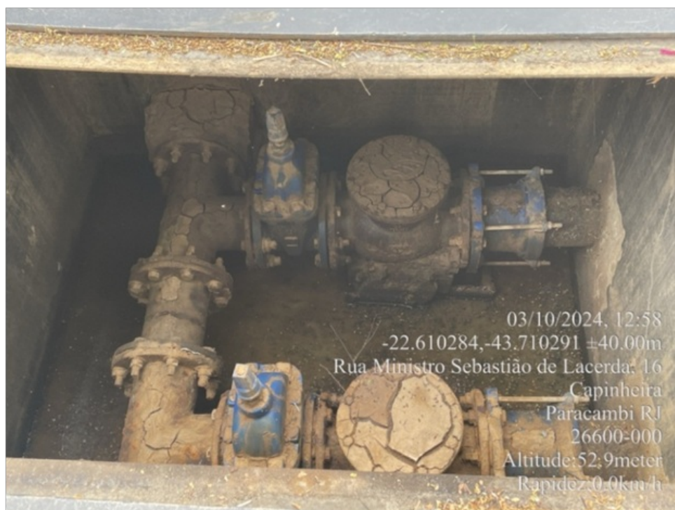
Foto 02 – Barrilete de recalque
