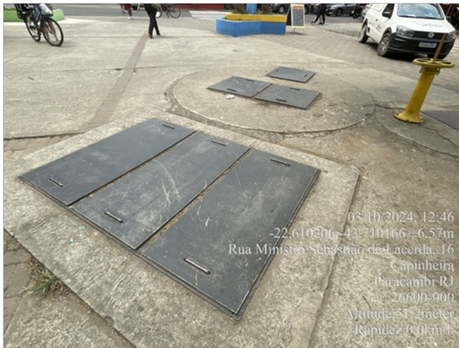
Foto 01 - Vista geral elevatória
