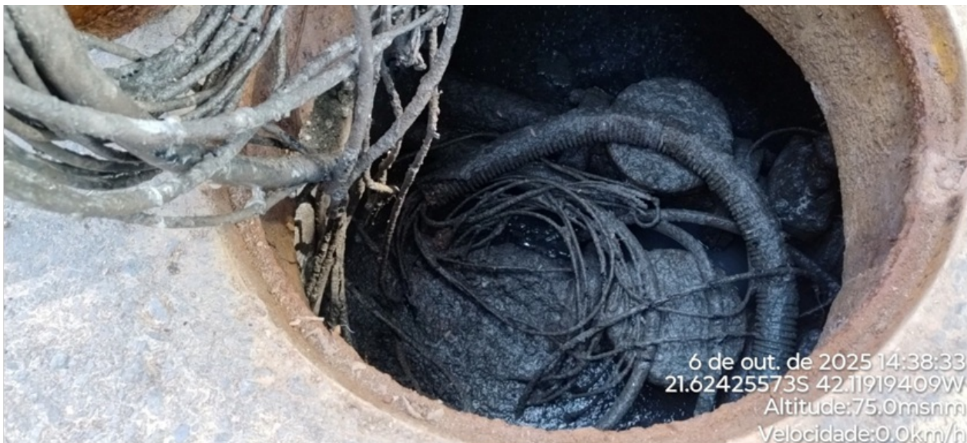
Foto 04 – Tubulação de recalque, válvulas de retenção e fechamento com a presença de vazamento de esgoto internamente.
