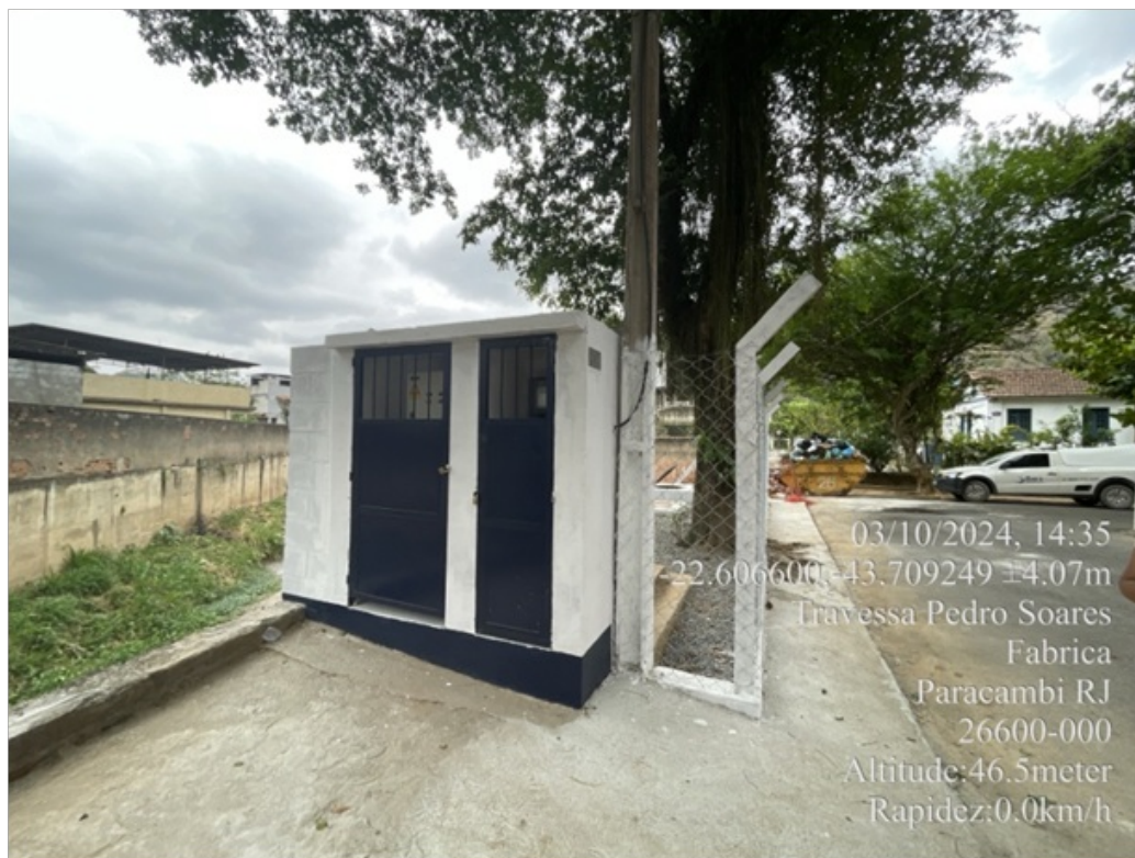
Foto 05 – Quadros de comando elétrico
