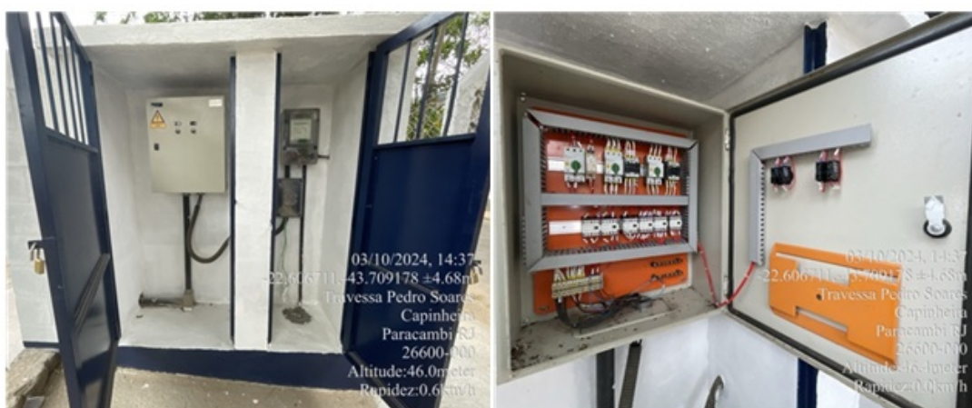
Foto 06 – Parte interna do quadro de comando
