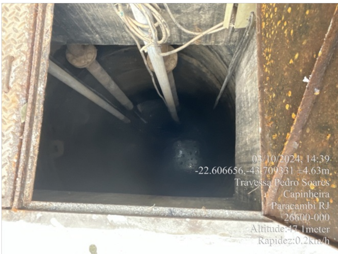
Foto 04 – Poço de sucção das bombas submersas
