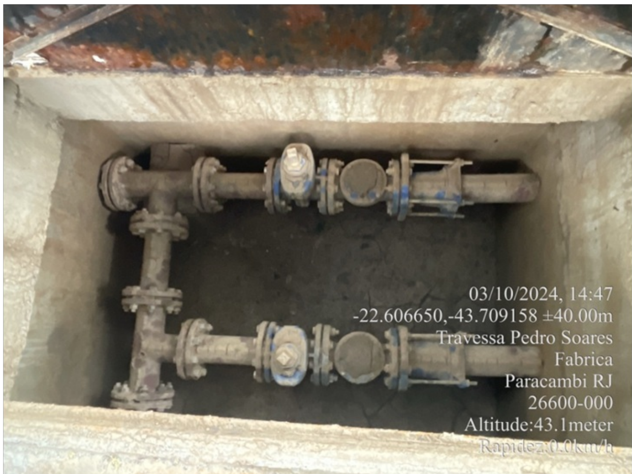
Foto 03 – Barrilete de recalque
