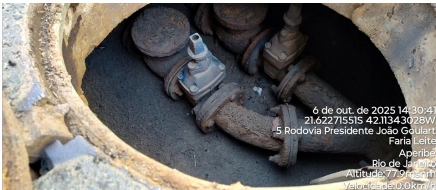
Foto 04 – Tubulação de recalque, válvulas de retenção e fechamento.
