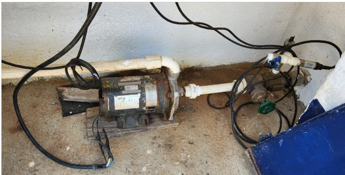
Foto 6 – A fiação não está adequadamente protegida
