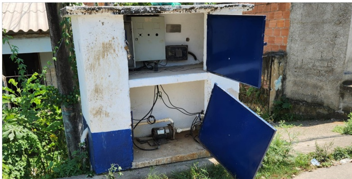
Foto 3 – Cabine e motobomba
