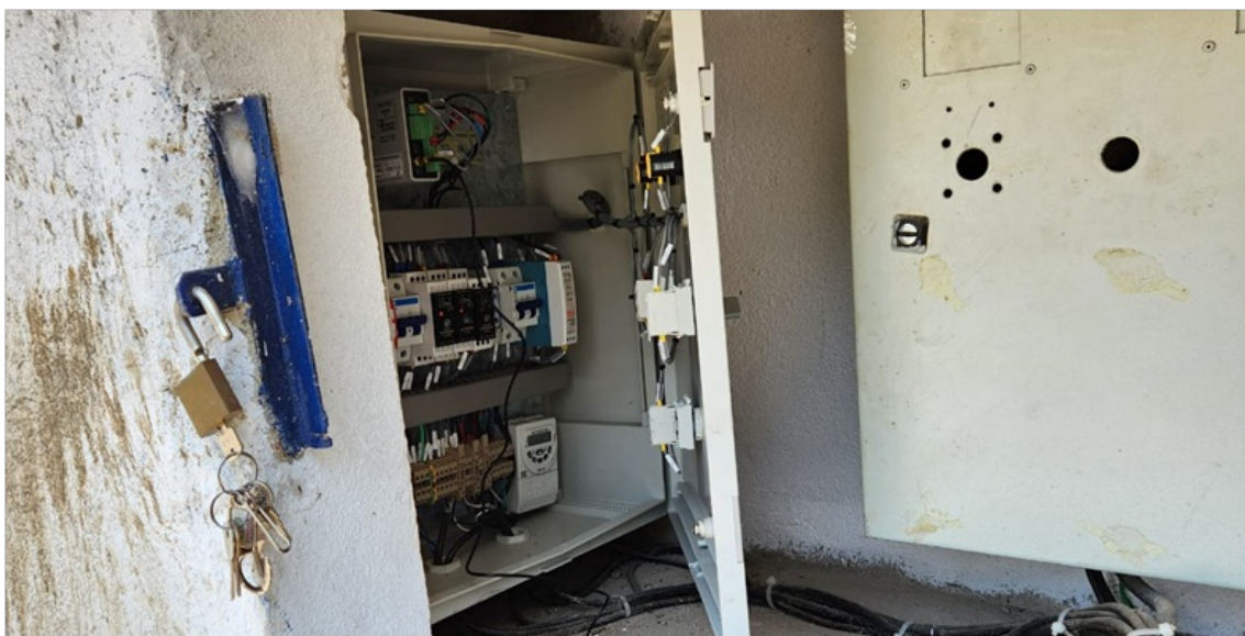
Foto 7 – Painel de automação do conjunto motobomba
