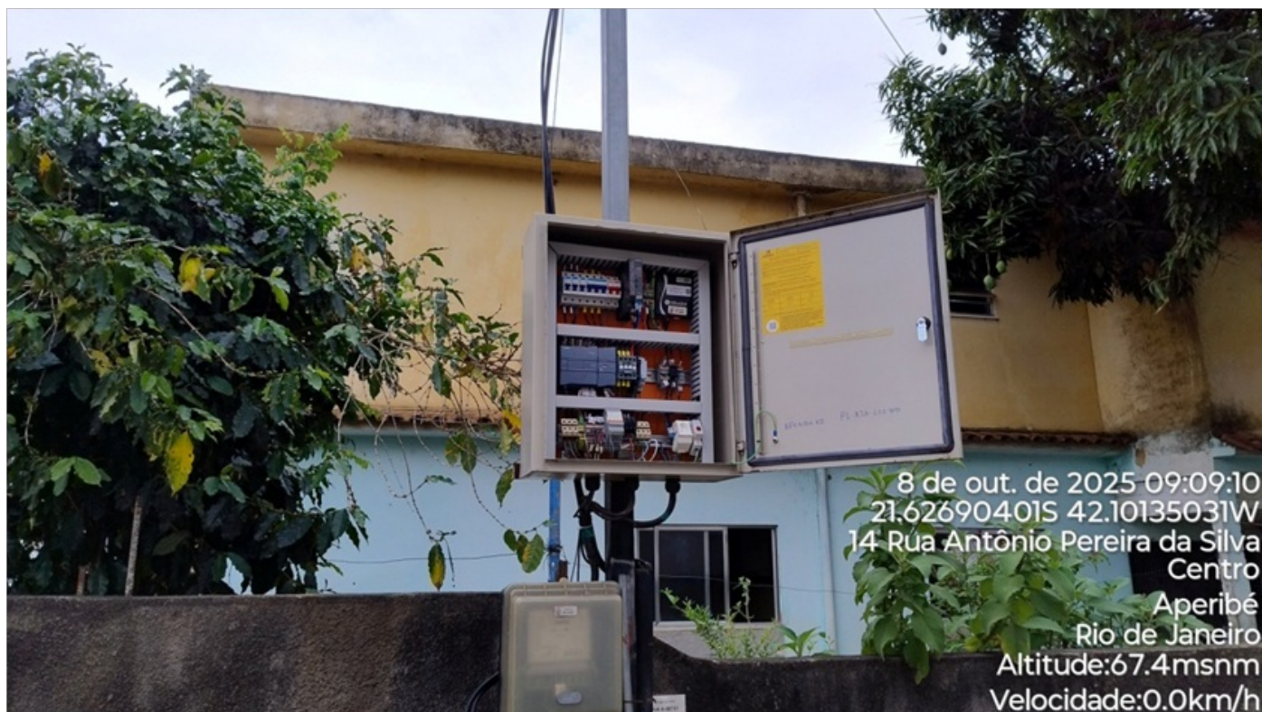
Foto 02 – Pannel de controle da EEE.
