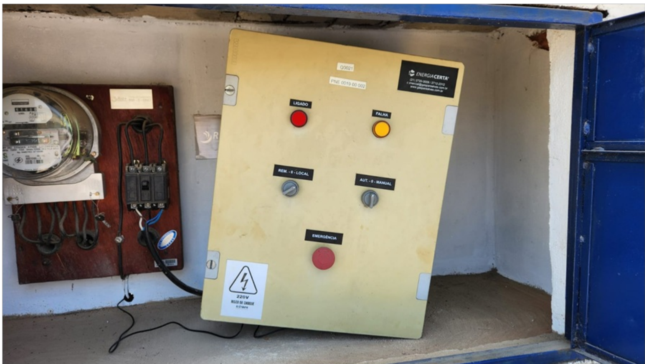
Foto 6 – Existência de informativo de choque elétrico
