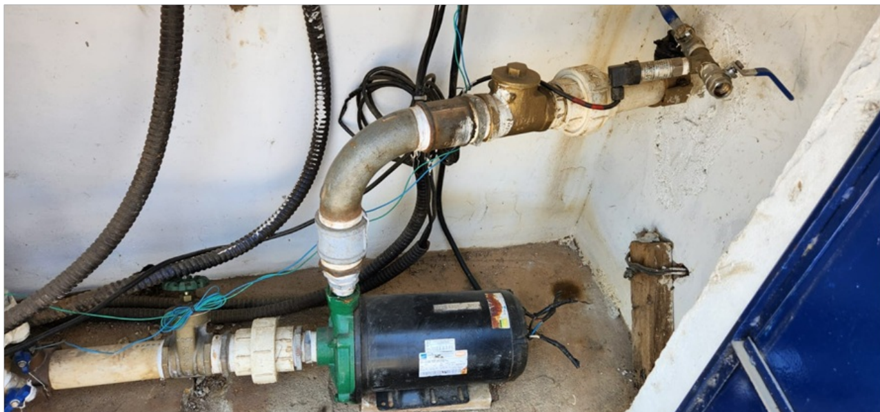
Foto 7 – A fiação não está adequadamente protegida
