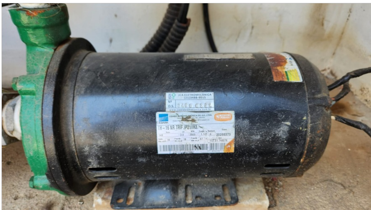
Foto 5 – Motobomba de 3 CV
