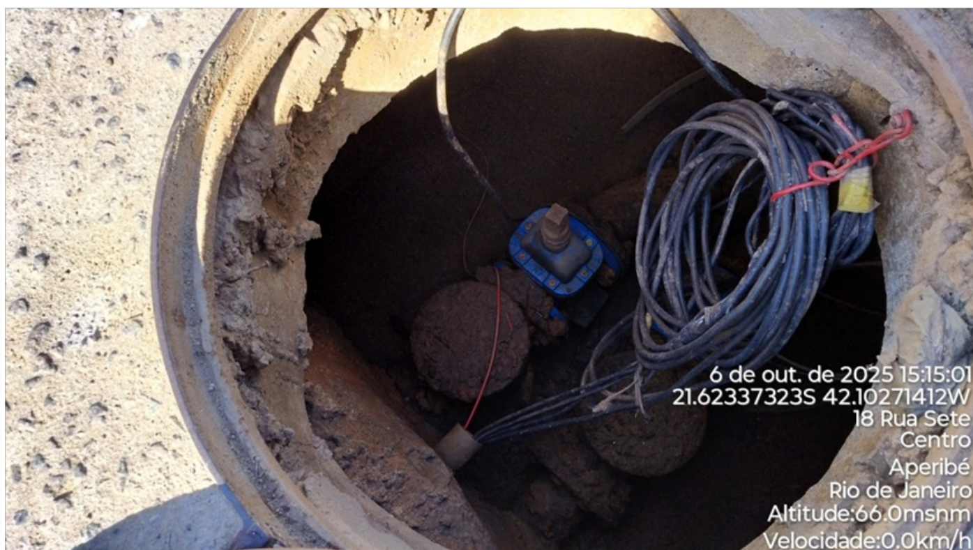
Foto 05 – Tubulação de recalque, válvulas de retenção e fechamento.
