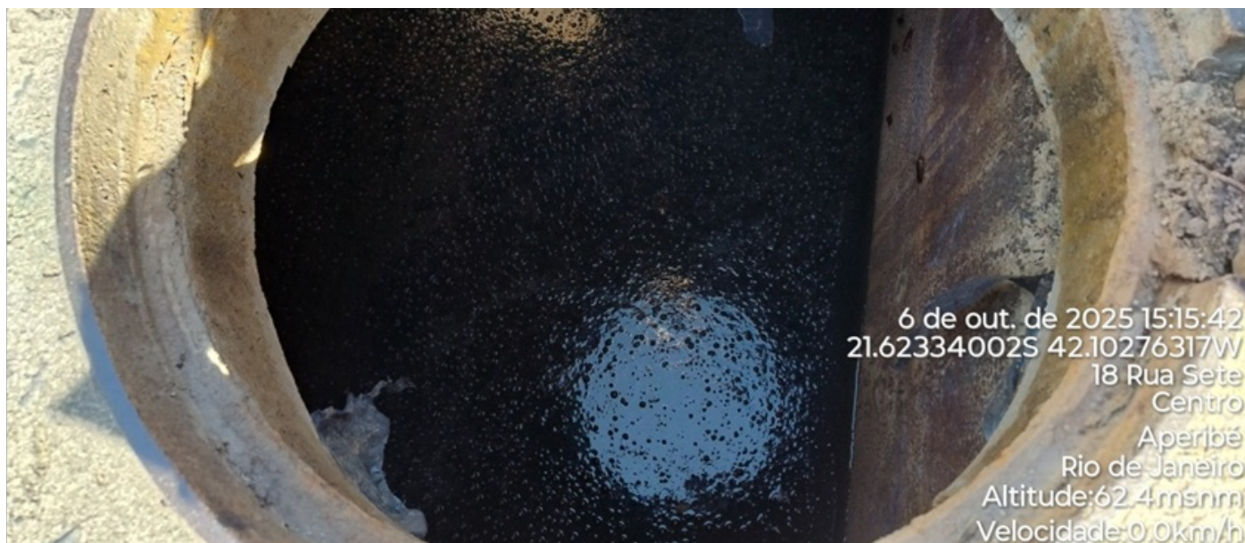
Foto 04 – Poço da motobomba submersível de recalque.
