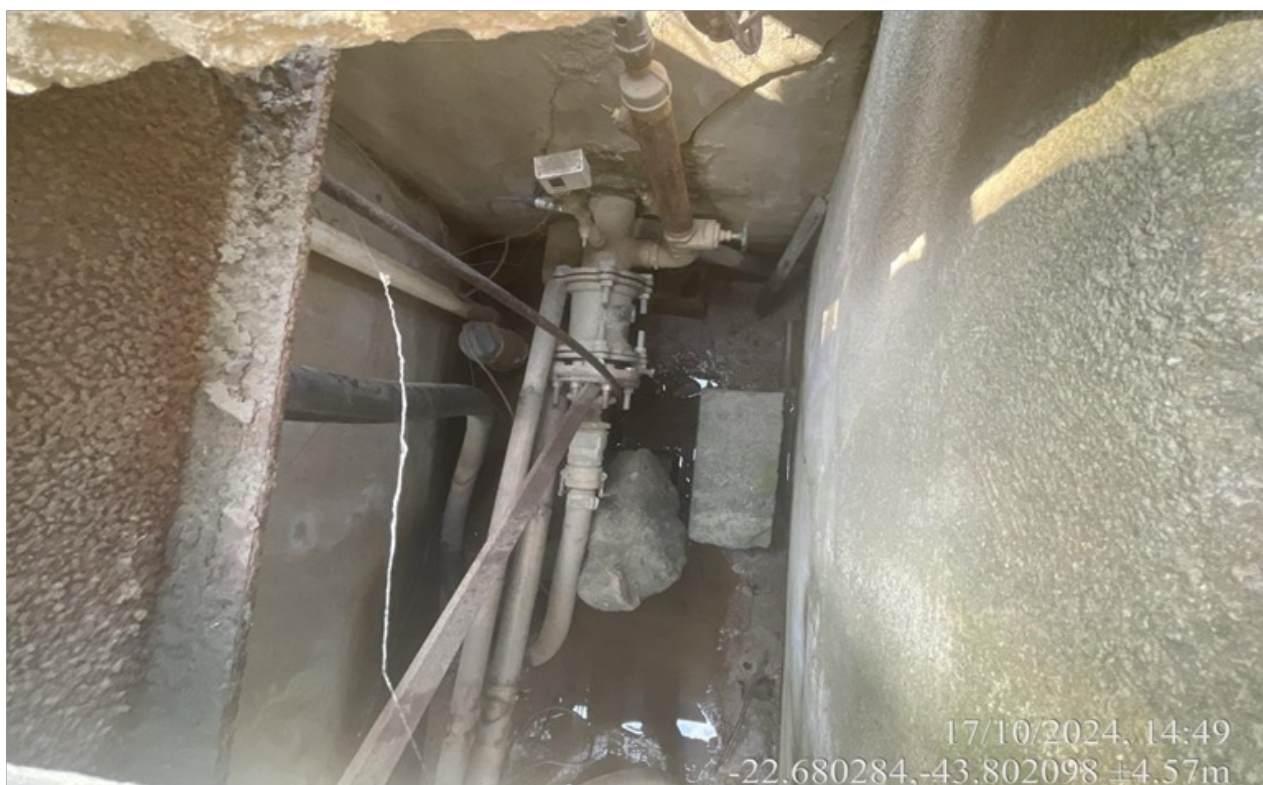
Foto 9 – Água no interior do abrigo
