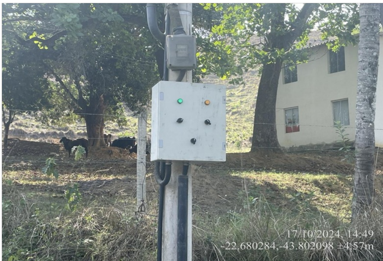
Foto 7 – Pannel elétrico da elevatória
