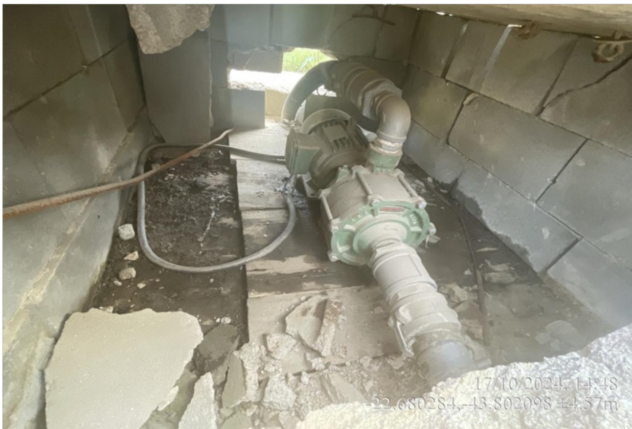
Foto 5 – Tubulação de sucção e de recalque
