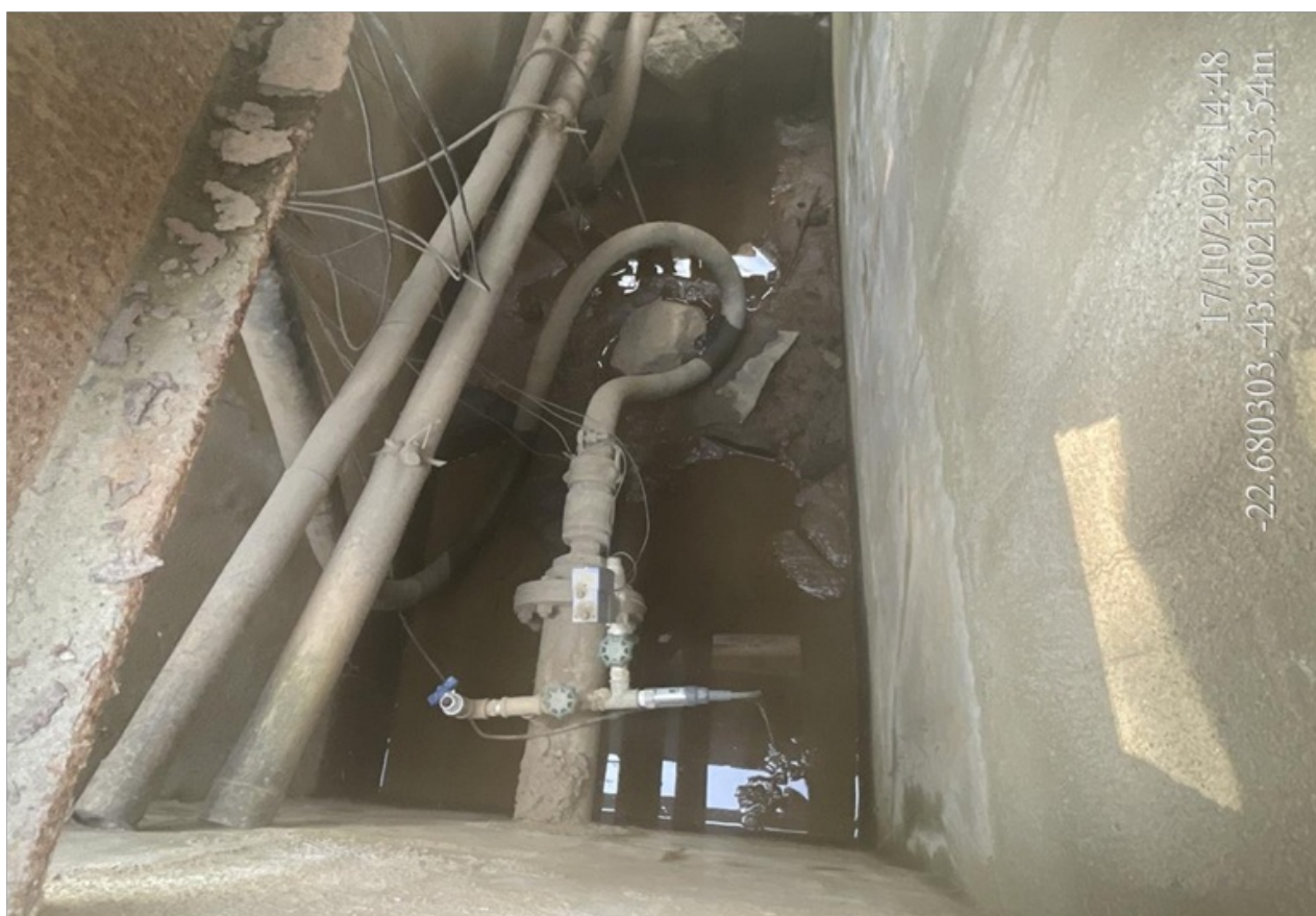
Foto 10 – Água no interior do abrigo
