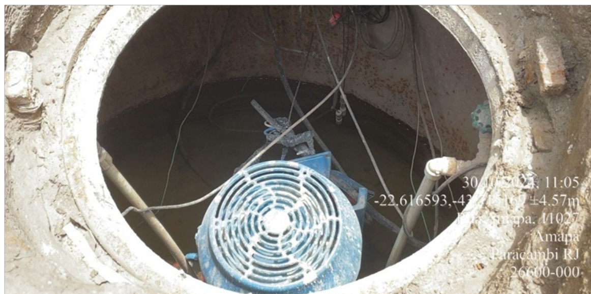
Foto 2 – Abrigo de aço (panelão)
