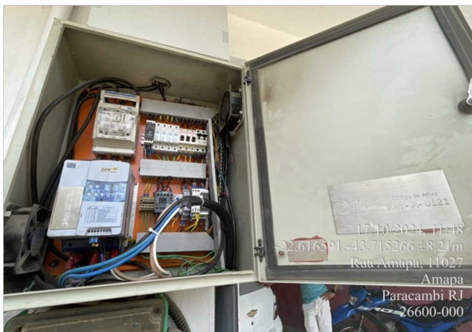
Foto 7 – Painel de automação
