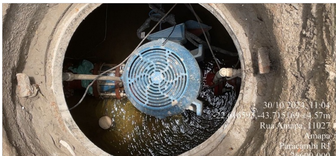
Foto 1 – Motobomba centrífuga “in line”
