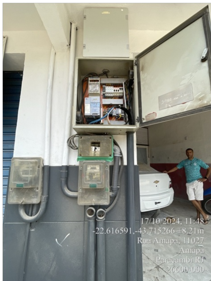
Foto 8 – Painel de automação e elétrico
