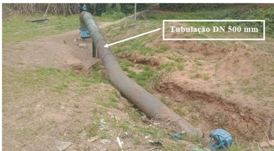
Foto 1 – Alça hidráulica (tubulação DN 500 mm) que sai da 1ª Adutora de Ribeirão das Lajes (1ª A.R.L.)
