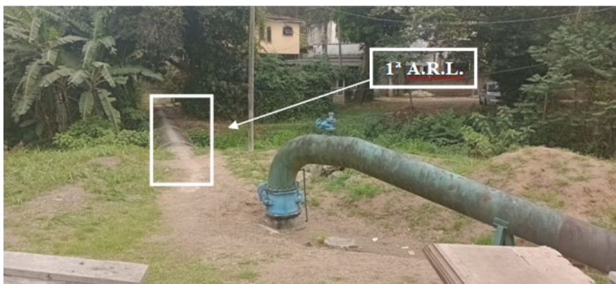
Foto 2 – Alça hidráulica (tubulação DN 500 mm) que sai da 1ª Adutora de Ribeirão das Lajes (1ª A.R.L.)
