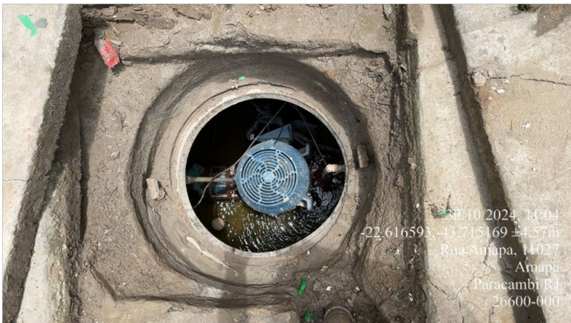
Foto 5 – Água no interior do abrigo
