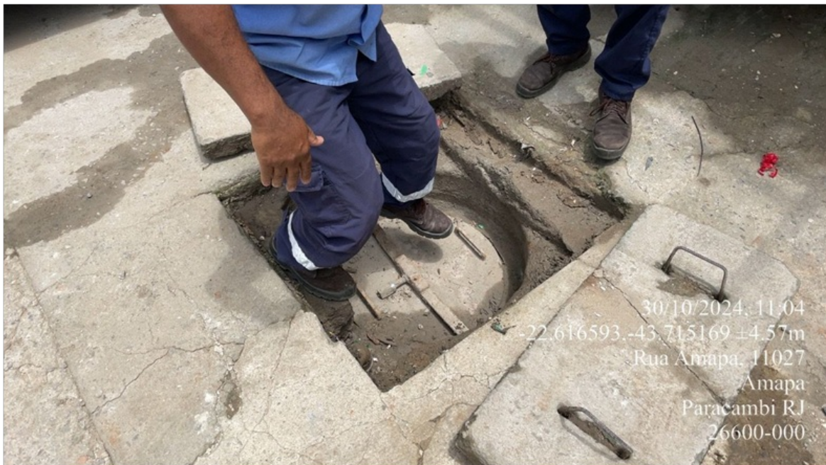
Foto 4 – Tampa de aço travada por uma haste
