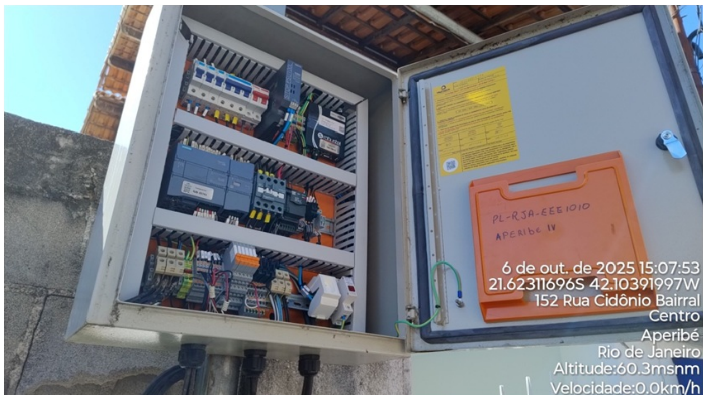
Foto 02 – Paineis de controle da elevatória de esgoto.
