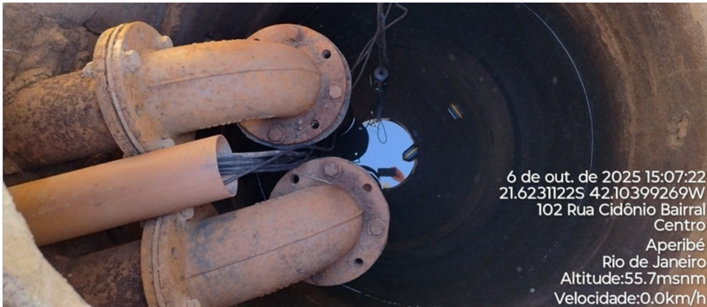
Foto 04 – Poço da motobomba submersível de recalque.
