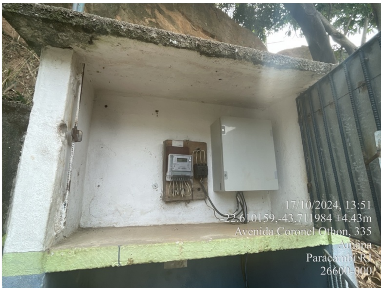
Foto 7 – Fiação sem proteção no painel
