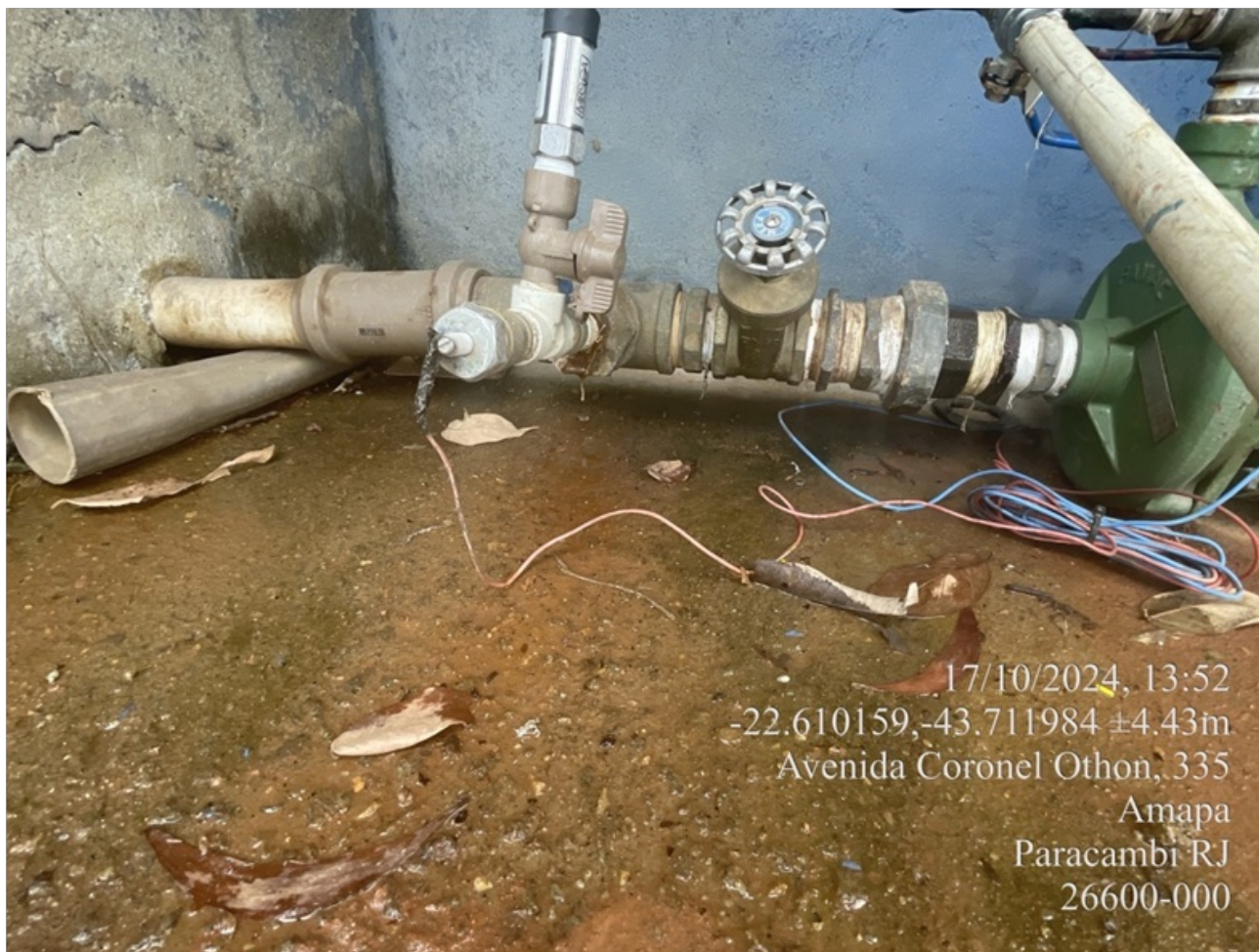
Foto 6 – Fiação exposta e água vazando
