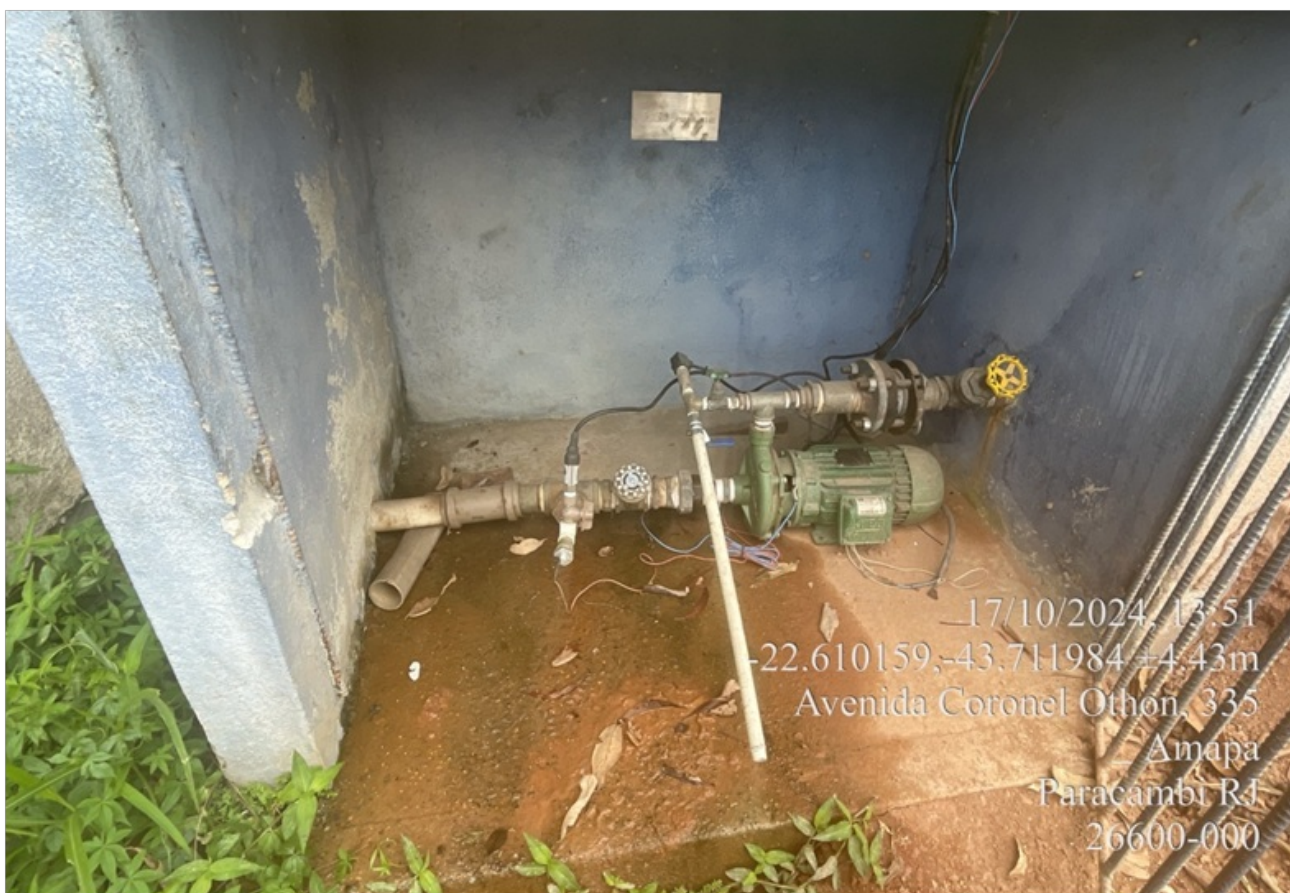
Foto 4 – Tubulação de sucção e de recalque
