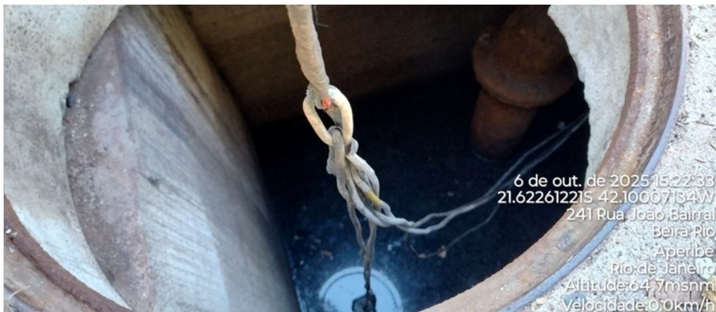
Foto 04 – Poço da motobomba submersível de recalque.
