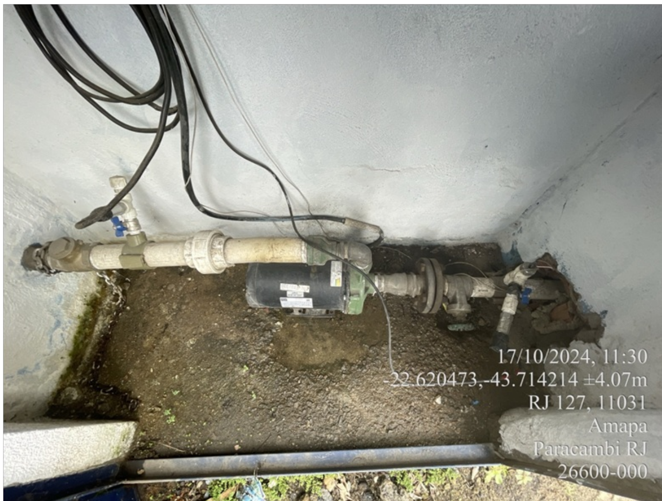
Foto 4 – Tubulação de recalque e sucção
