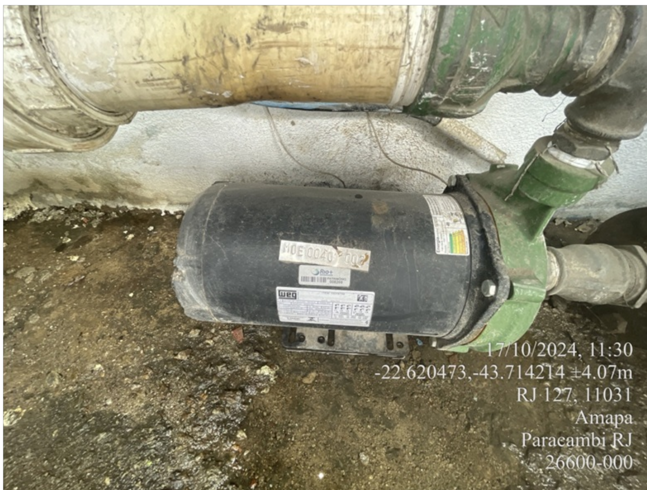
Foto 6 – Água acumulada de vazamento da tubulação
