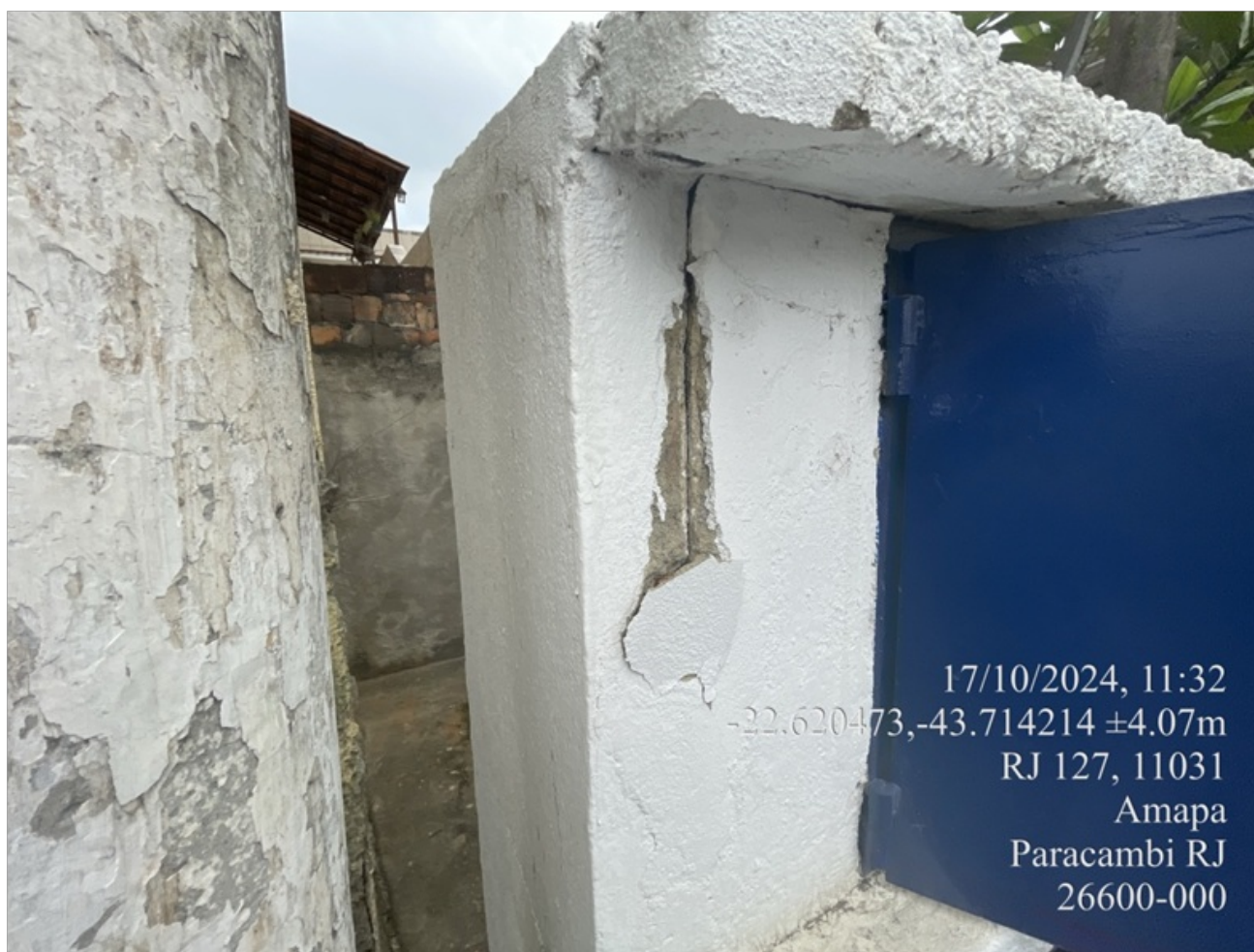
Foto 5 – Rachadura na alvenaria
