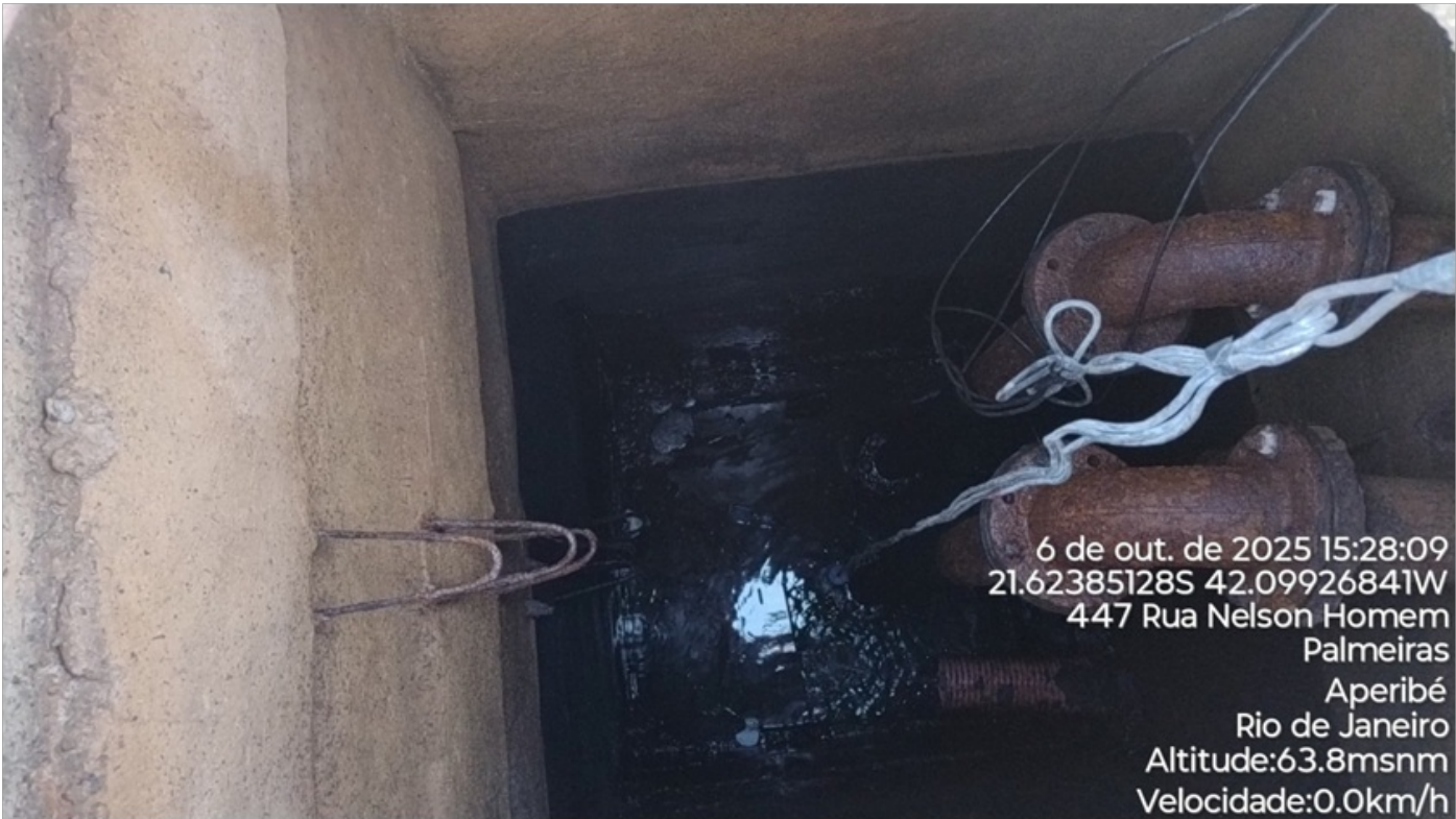
Foto 02 – Poço da motobomba submersível de recalque.
