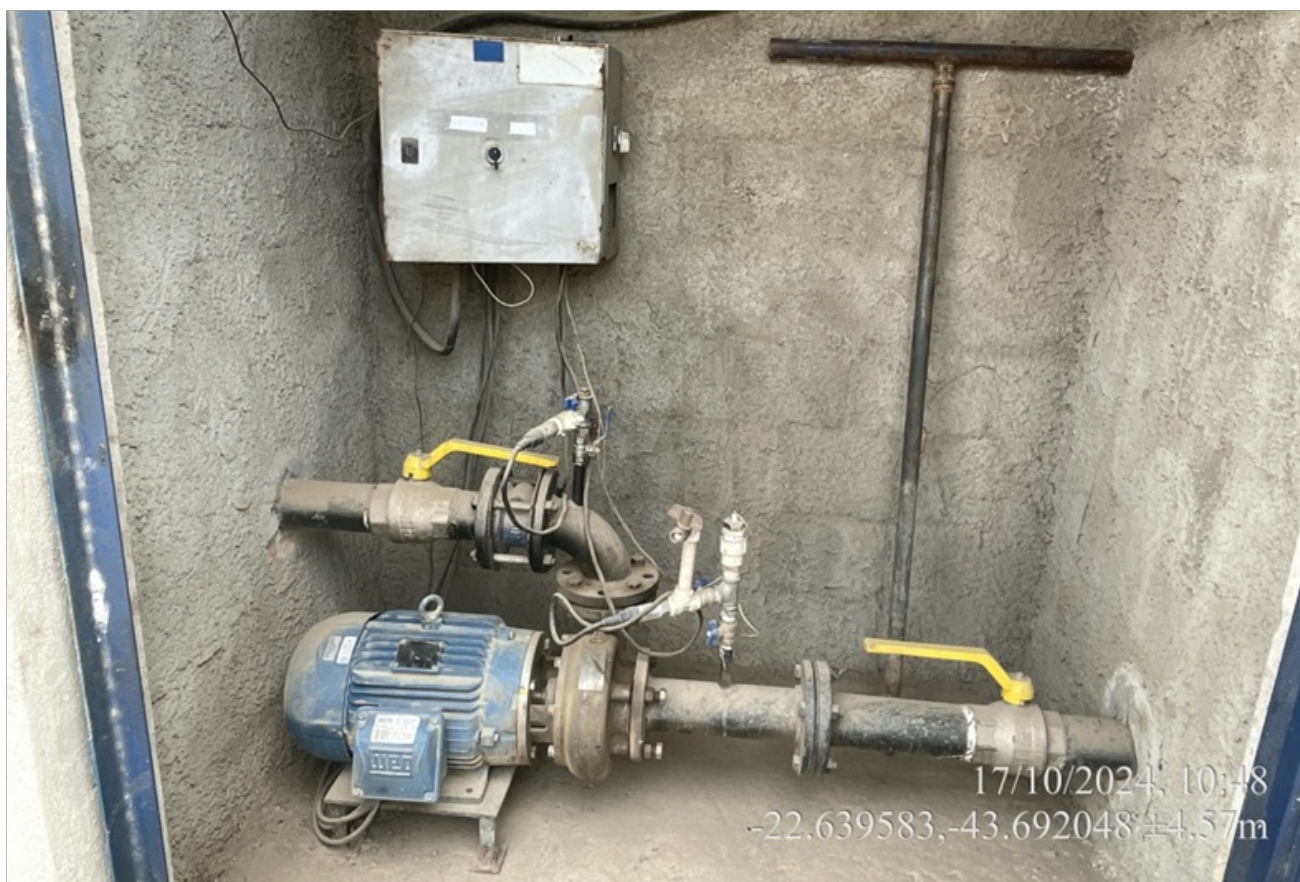
Foto 4 – Tubulação de sucção e de recalque
