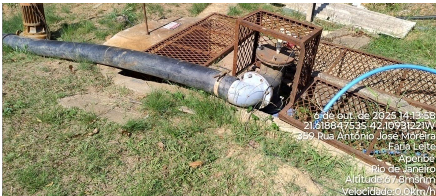
Foto 04 – Abrigo do conjunto motobomba.
