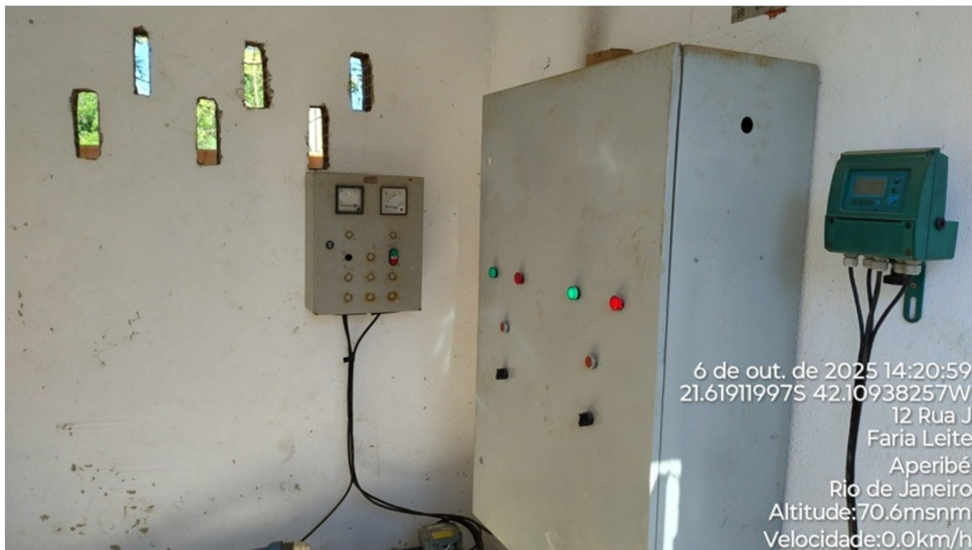
Foto 06 – Painel de controle da EEAB.
