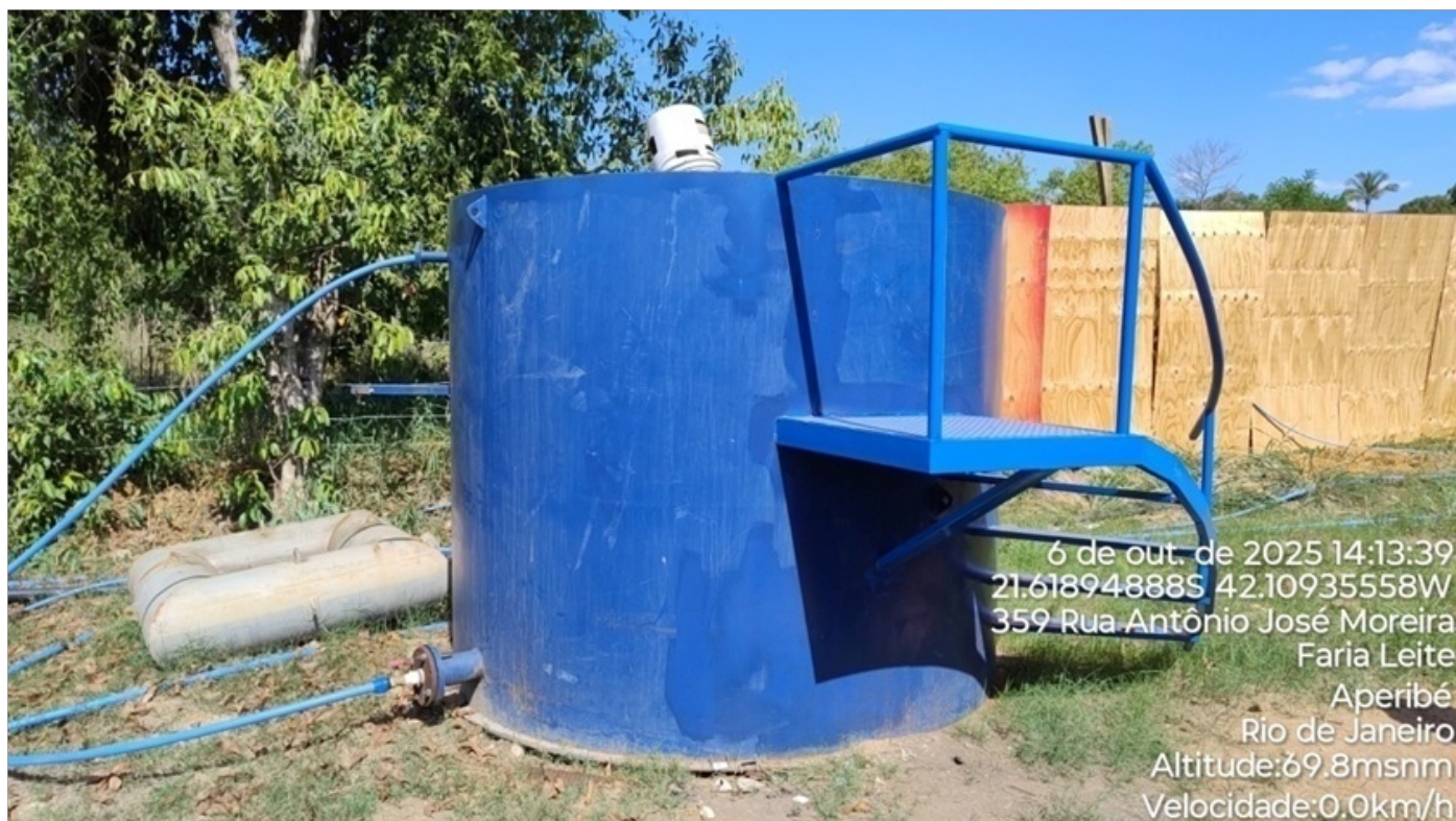
Foto 05 – Equipamento para adição de carvão ativado.
