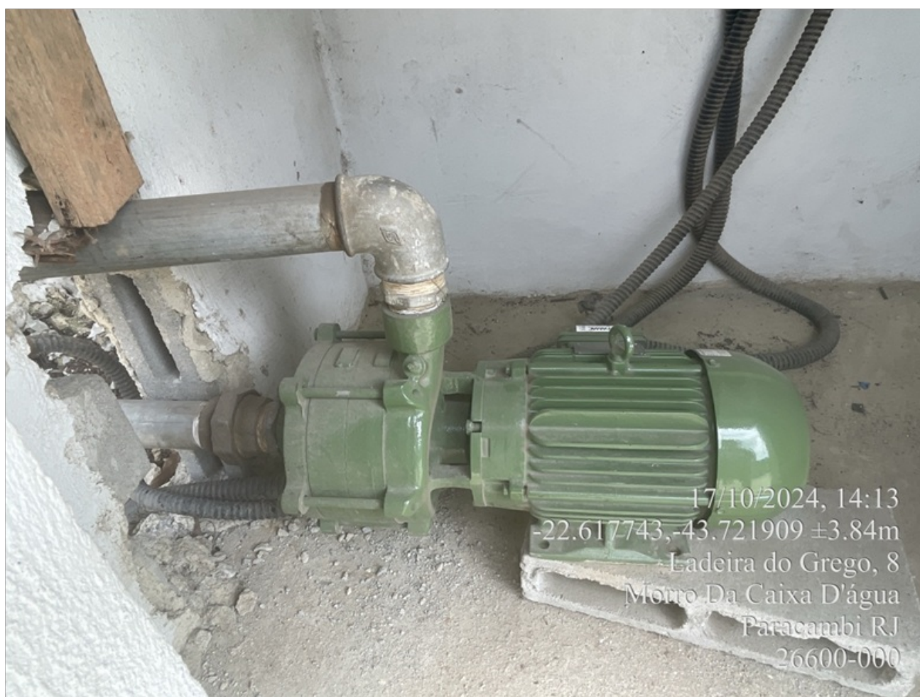
Foto 4 – Tubulação de sucção e de recalque
