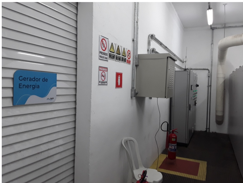
Foto 16 – Sinalizações de advertência
