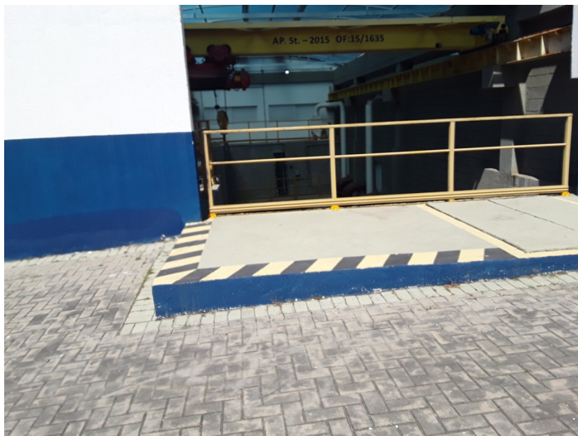
Foto 10 – Guarda corpo e sinalização de piso
