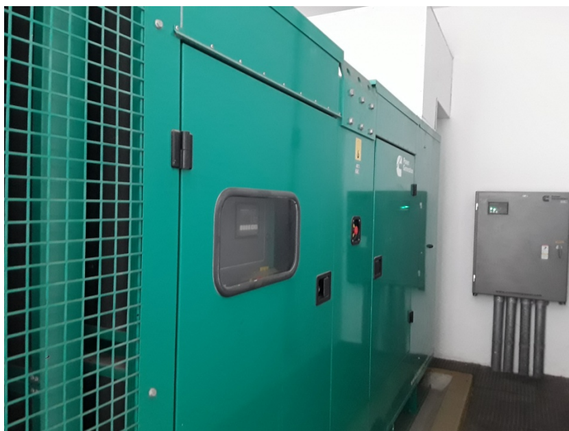
Foto 28 – Gerador com bacia de contenção
