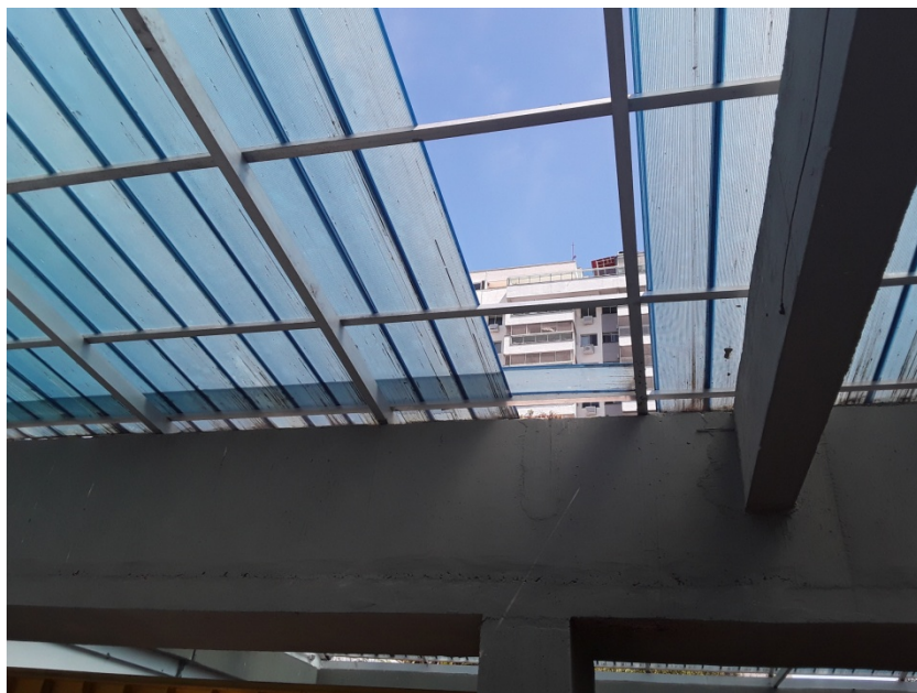
Foto 19 – Trecho da cobertura do poço das motobombas com falta de telha
