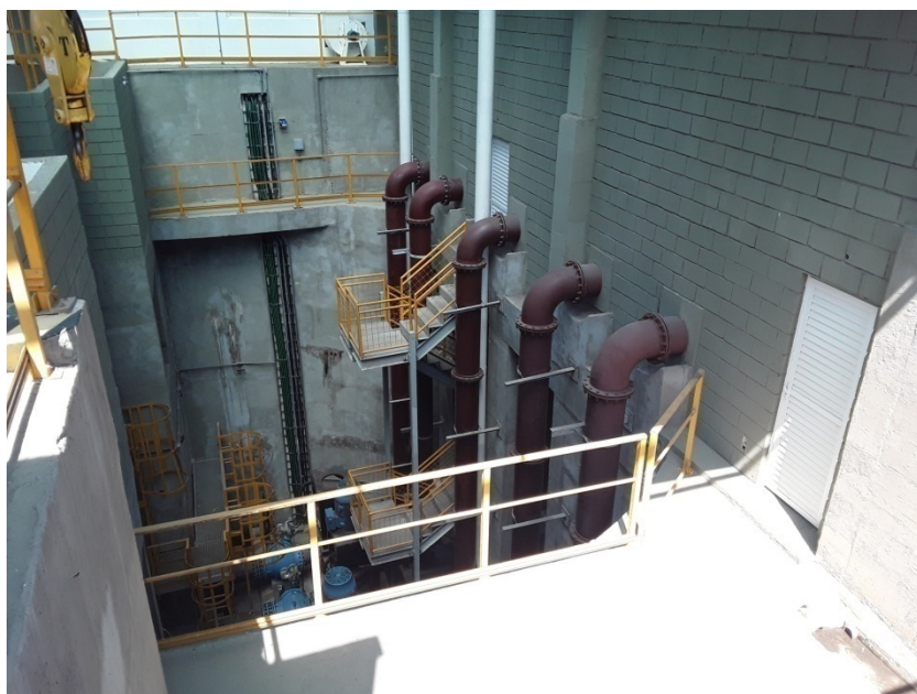
Foto 24 – Tubulações de recalque
