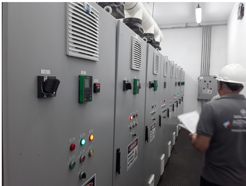
Foto 15 – Painéis elétricos das motobombas e sinalizações de advertência
