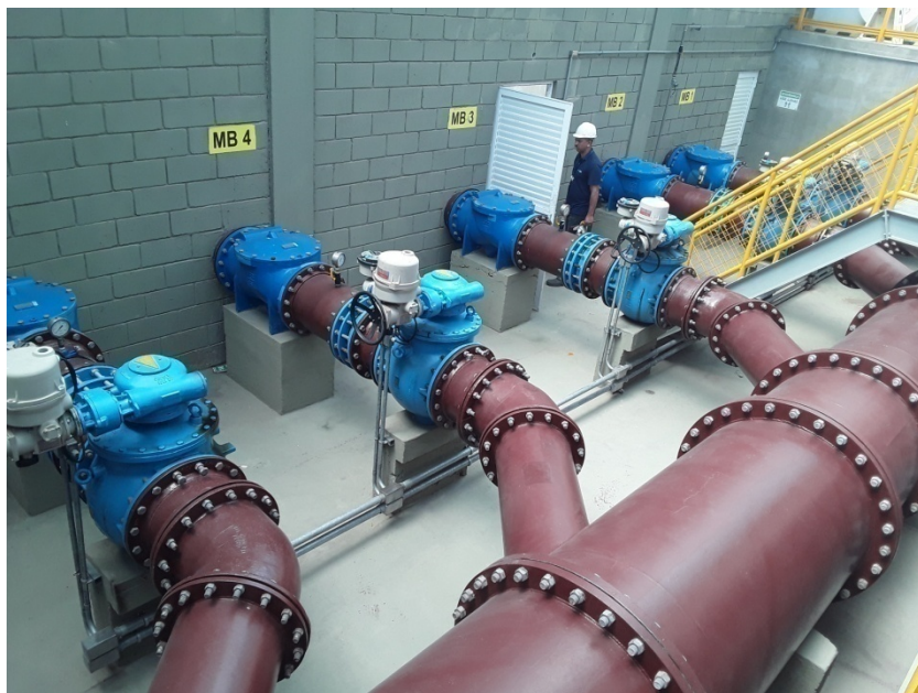
Foto 25 – Válvulas de fechamento e retenção
