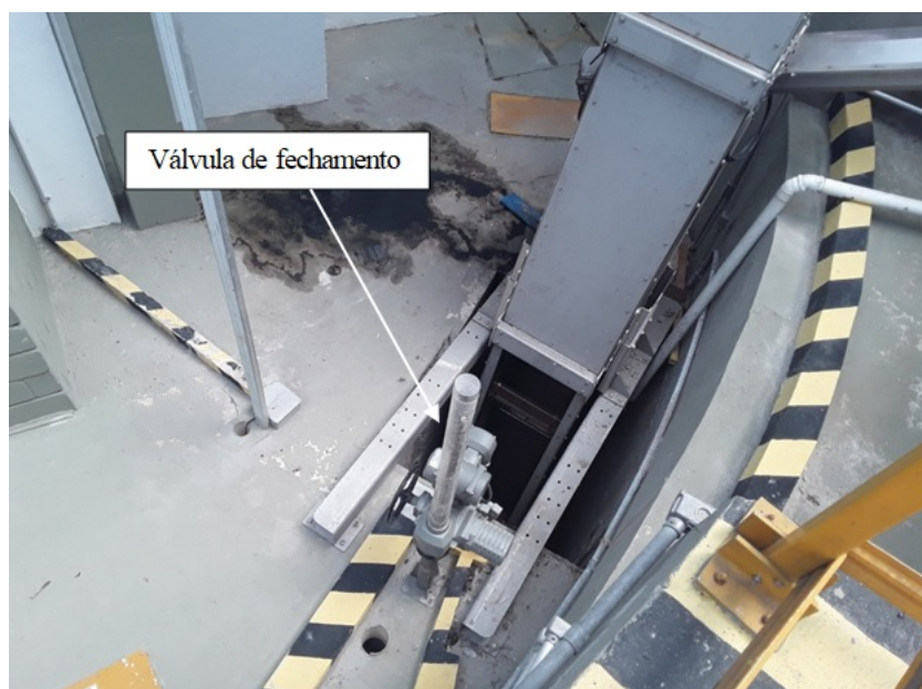
Foto 4 – Gradeamento mecânico de um dos poços de sucção na chegada do esgoto
