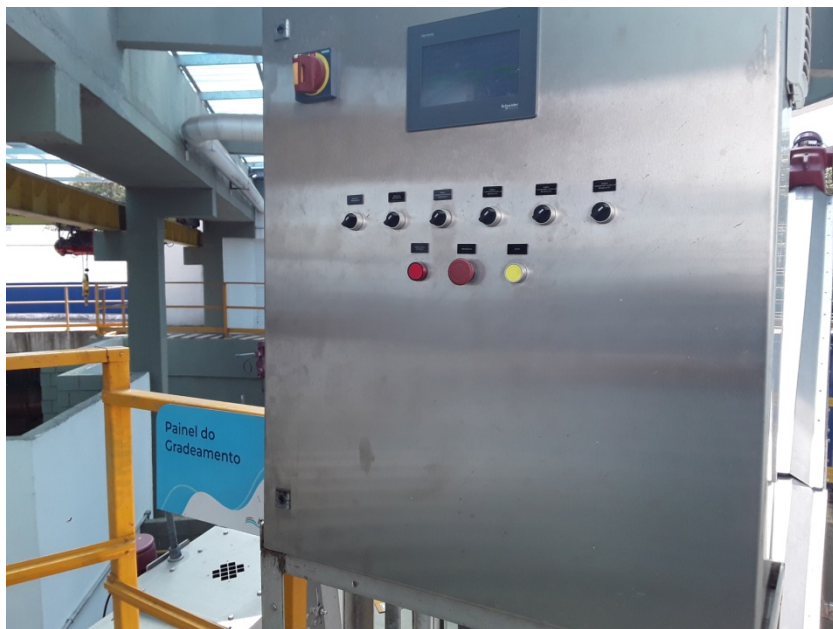
Foto 9 – Painel elétrico do gradeamento
