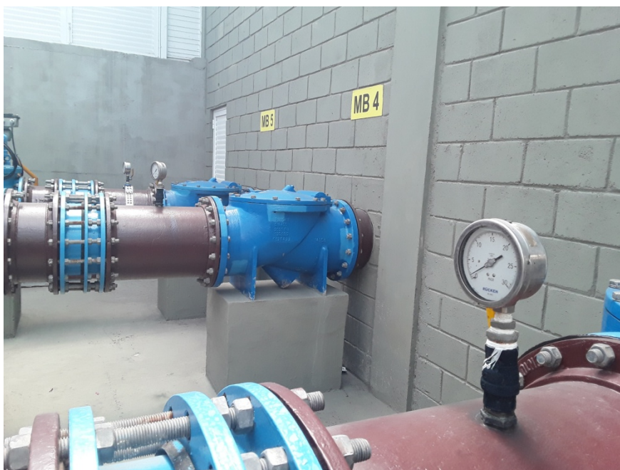
Foto 27 – Manômetros nas linhas de recalque
