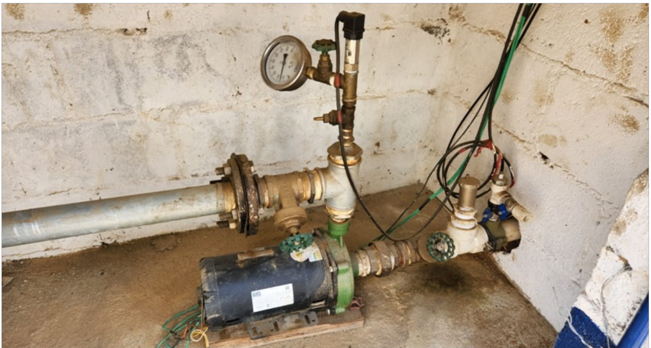
Foto 4 – Tubulação de retaguarda e recalque
