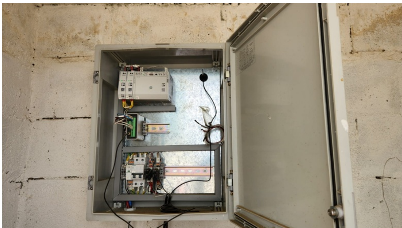
Foto 5 – Fiação elétrica que sai do painel está desprotegida
