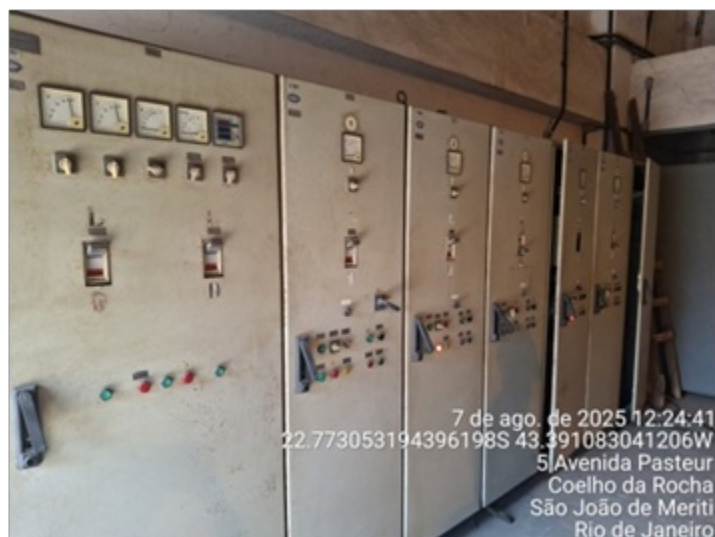
Foto 6 – Painéis de controle e automação
