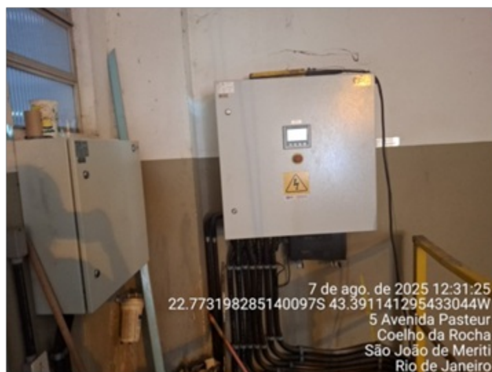
Foto 7 – PAINEL de automação
