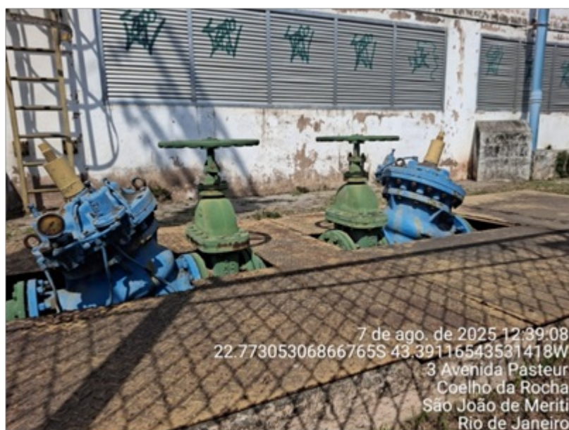
Foto 5 – Saída tubulações de recalque
