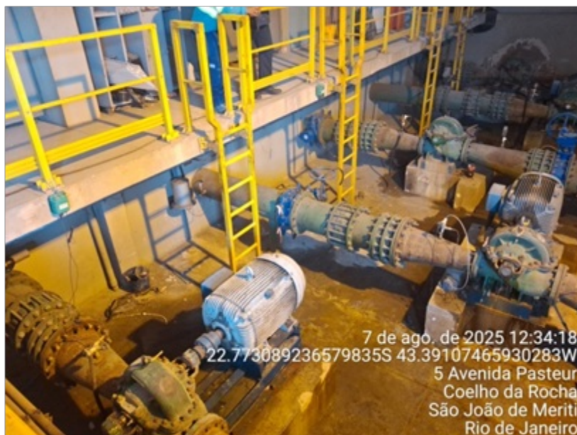
Foto 3 – Barrilete do booster e conjuntos motobombas
