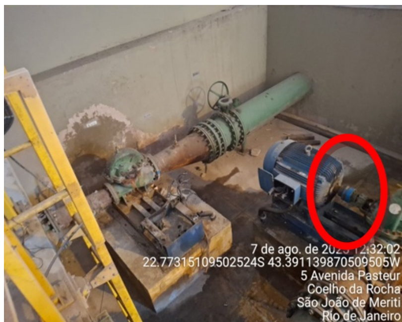
Foto 12 – Acoplamento motor e bomba (destaque)
