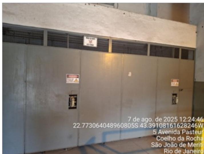
Foto 10 – Subestação de energia
