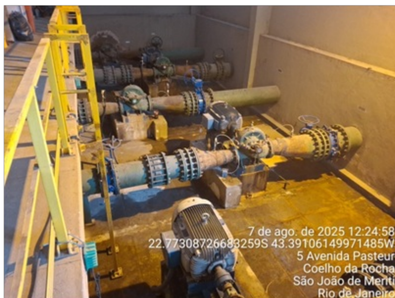
Foto 4 – Barrilete do booster e conjuntos motobombas
