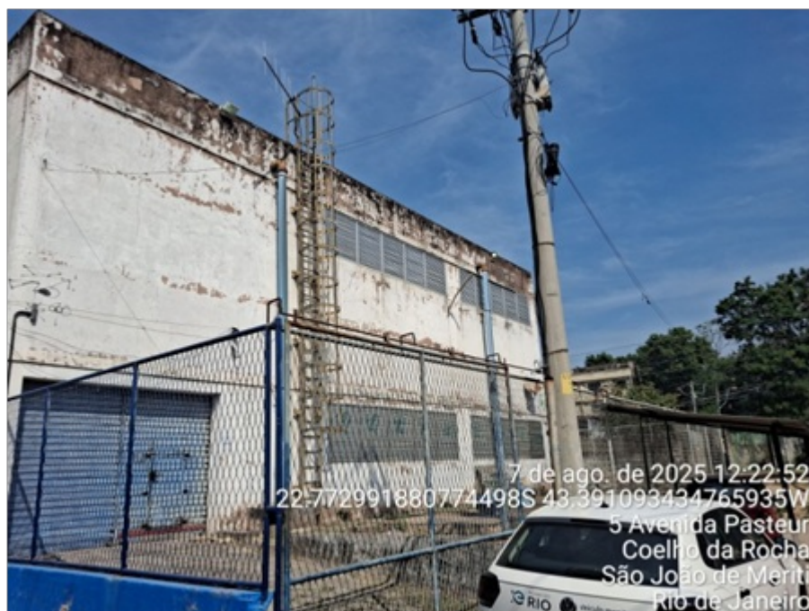
Foto 1 – Abrigo booster (ou elevatória)
