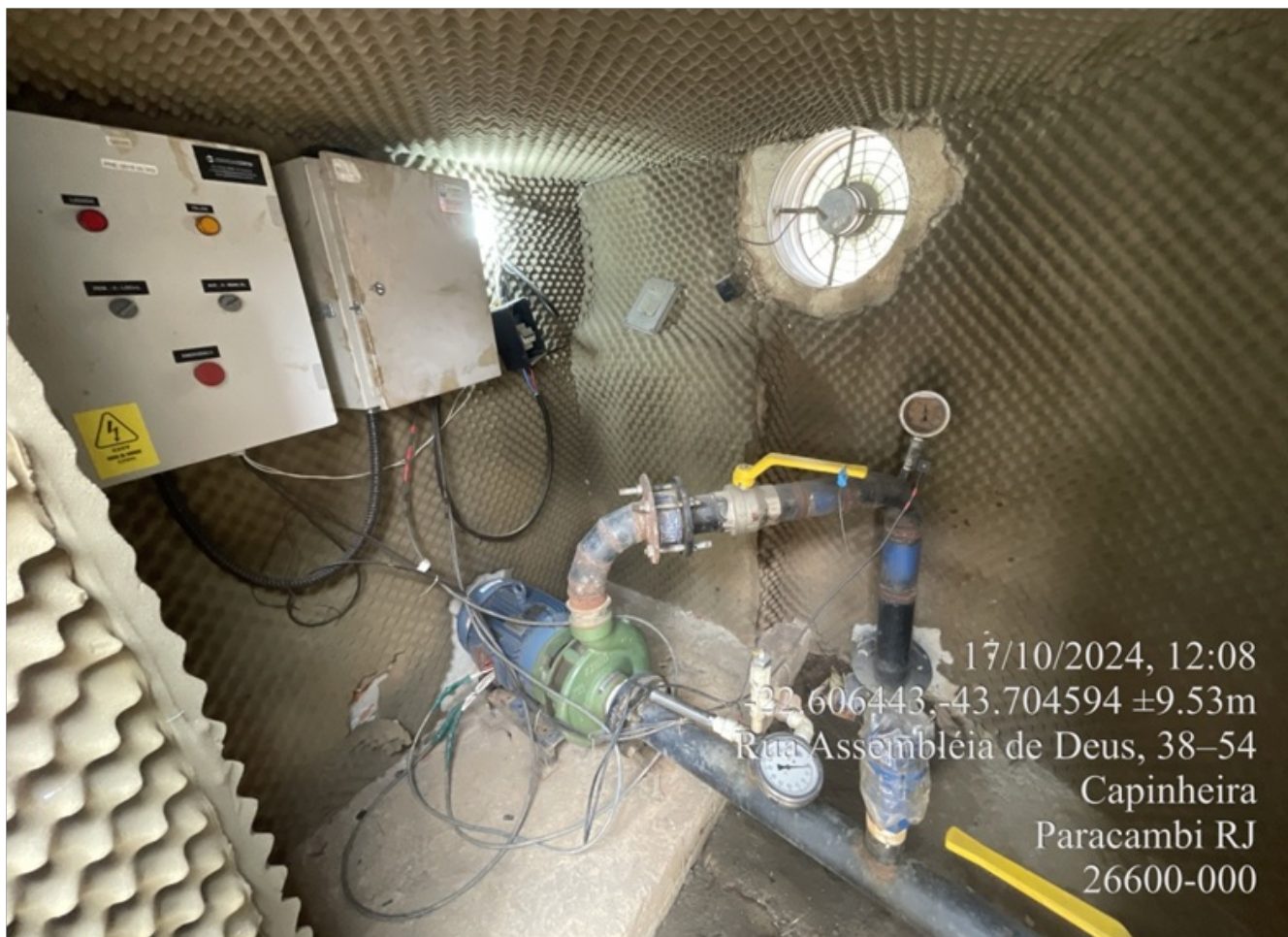
Foto 5 – Painéis elétricos, fiação e saída de ar
