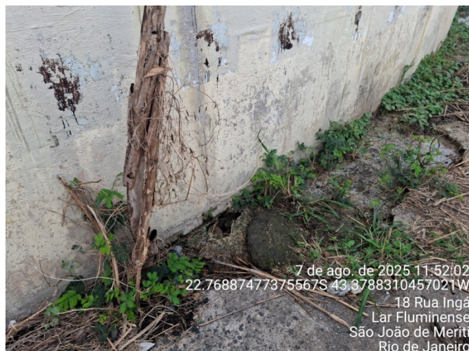
Foto10: Vazamento no reservatório
