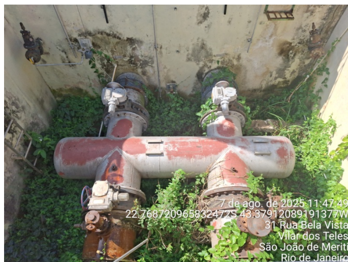
Foto 3: Barrilete do reservatório
