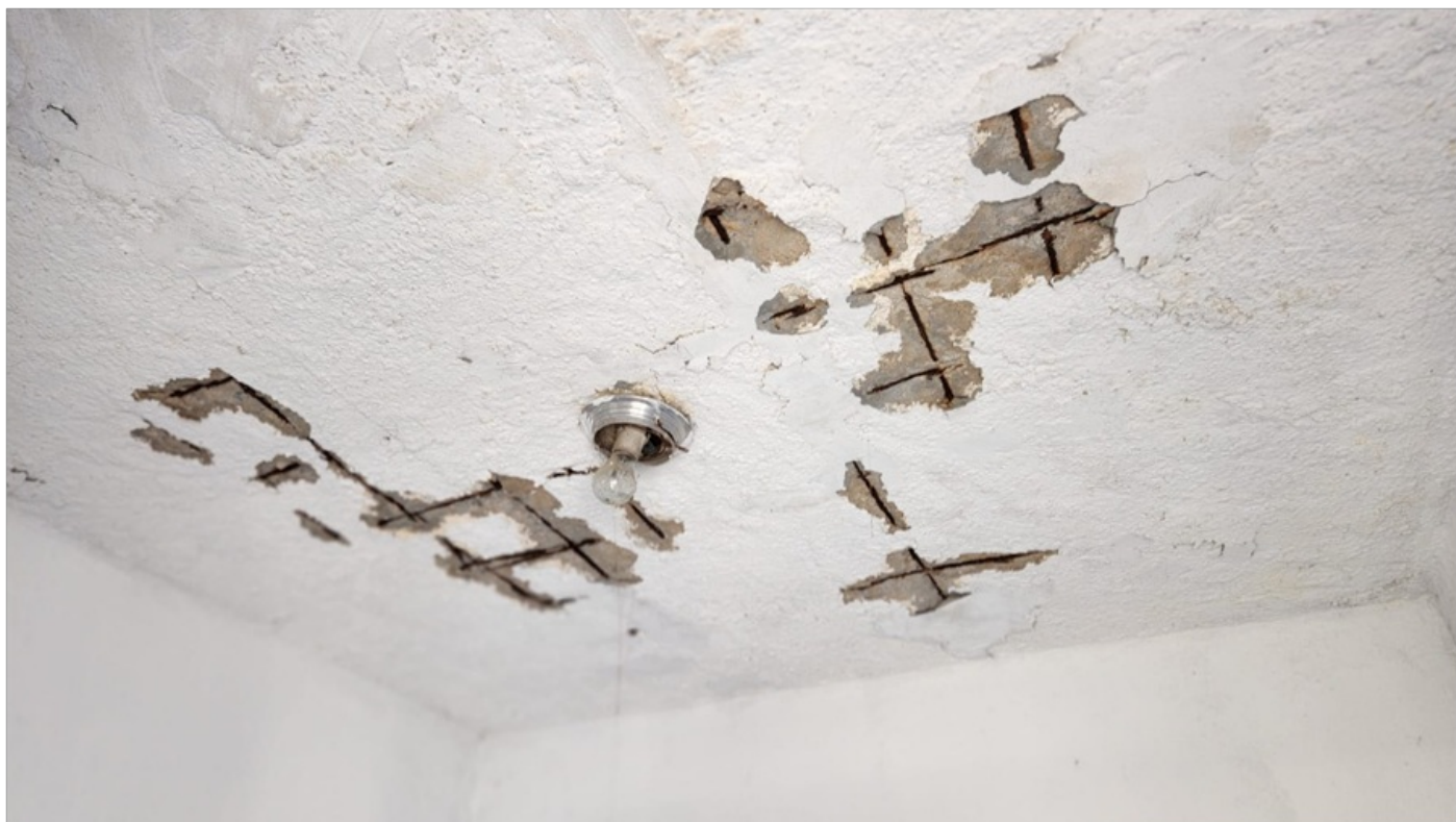
Foto 5 – Ferragem aparente na laje
