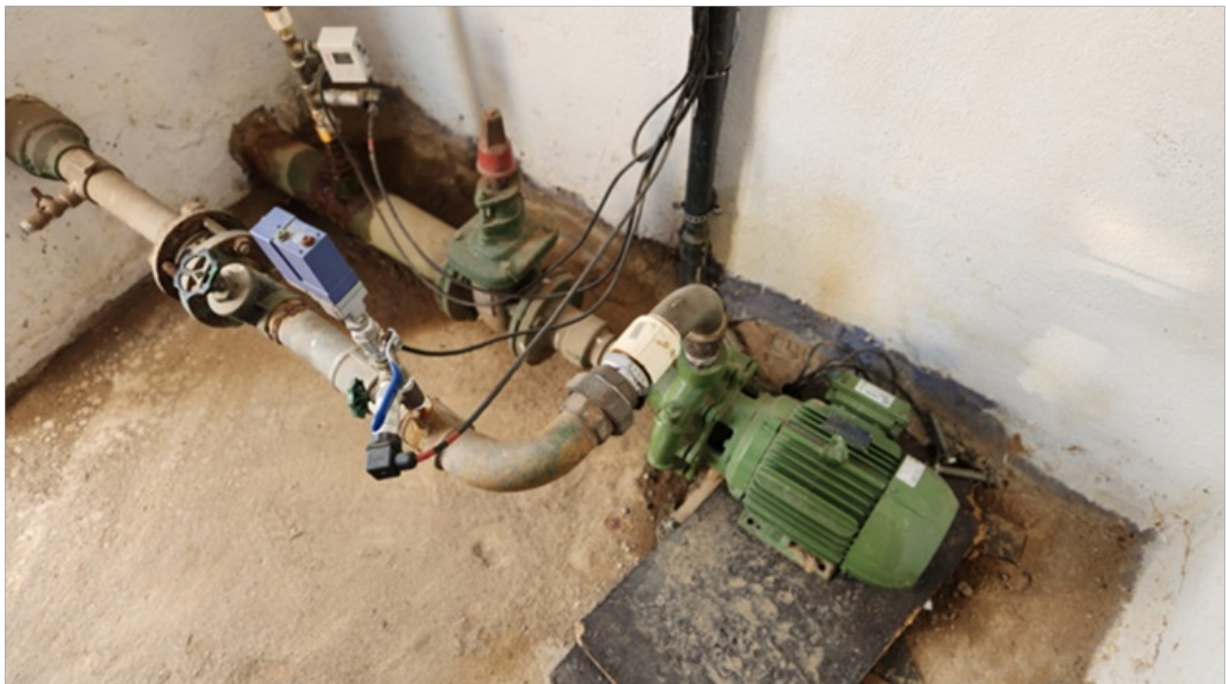
Foto 4 – Tubulação de retaguarda e recalque
