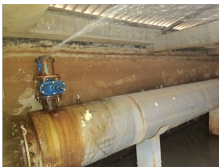
Foto 19 – Vazamento em ventosa da Linha de Recalque
