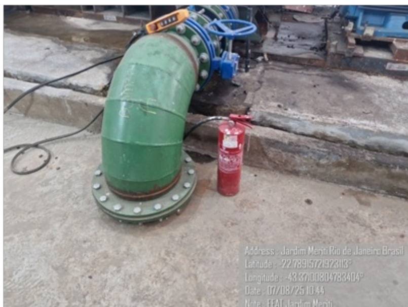
Foto 13 – Extintor de incêndio mal instalado
