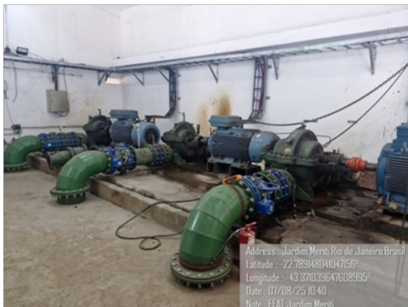
Foto 3 – Barrilete do booster e conjuntos motobombas
