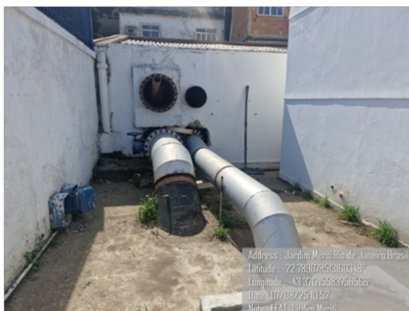
Foto 5 – Saída tubulações de recalque
