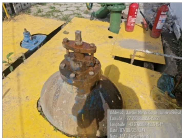
Foto 16 – Pequeno vazamento em válvula
