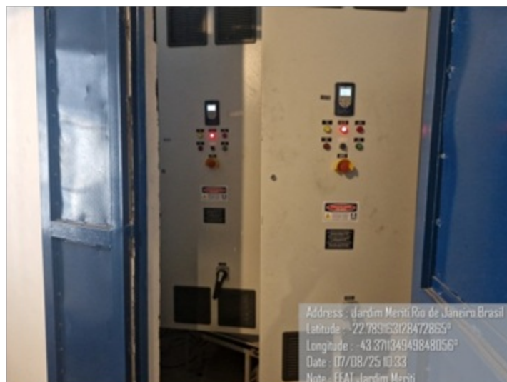
Foto 6 – Painéis de controle e automação
