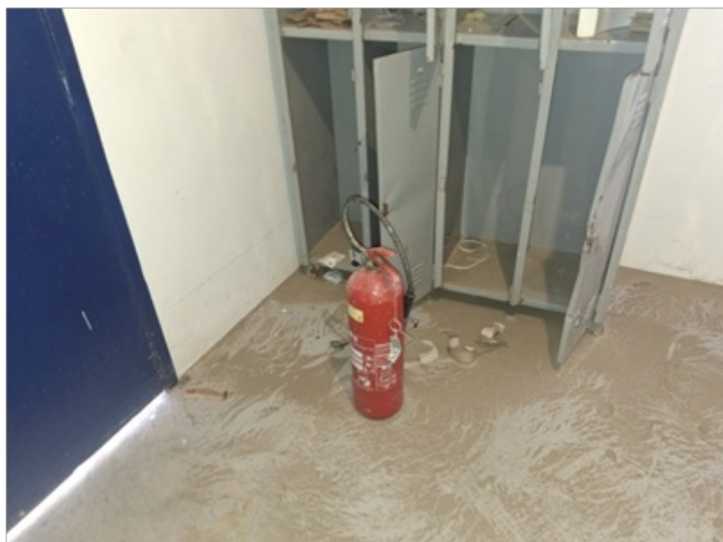
Foto 12 – Extintor de incêndio mal instalado
