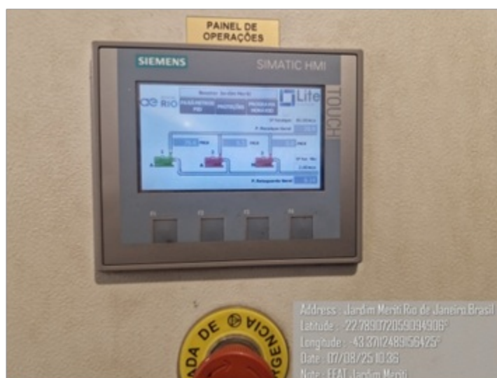
Foto 9 – Visor painel de controle
