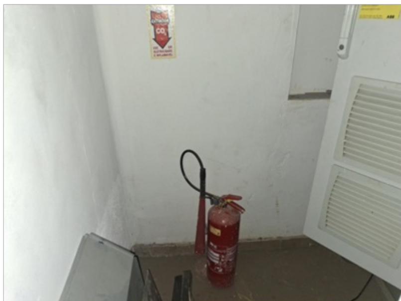
Foto 11 – Extintor de incêndio mal instalado
