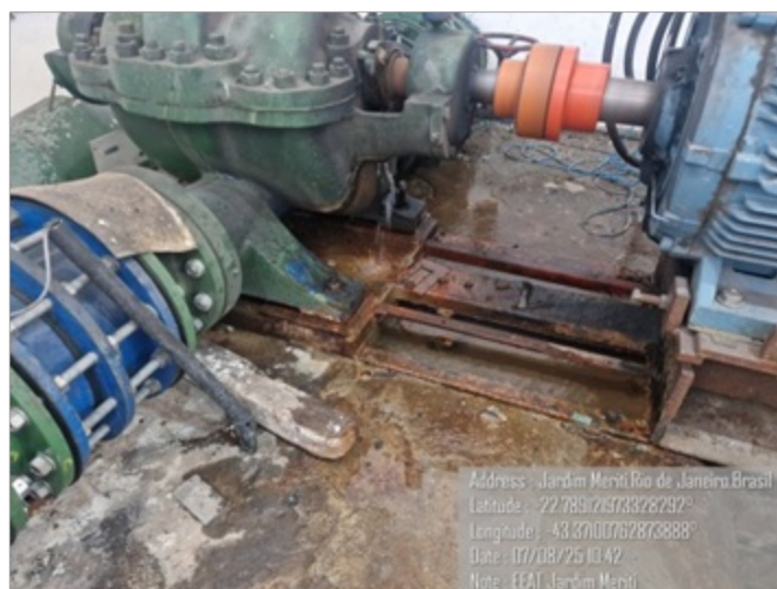
Foto 15 – Acoplamento motor e bomba sem proteção
