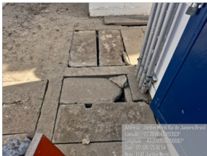
Foto 17 – Tampas de concreto avariadas
