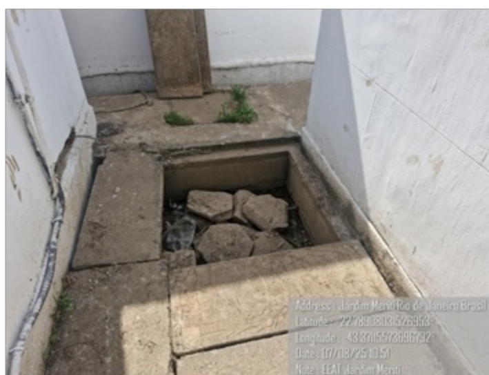
Foto 18 – Tampas de concreto avariadas
