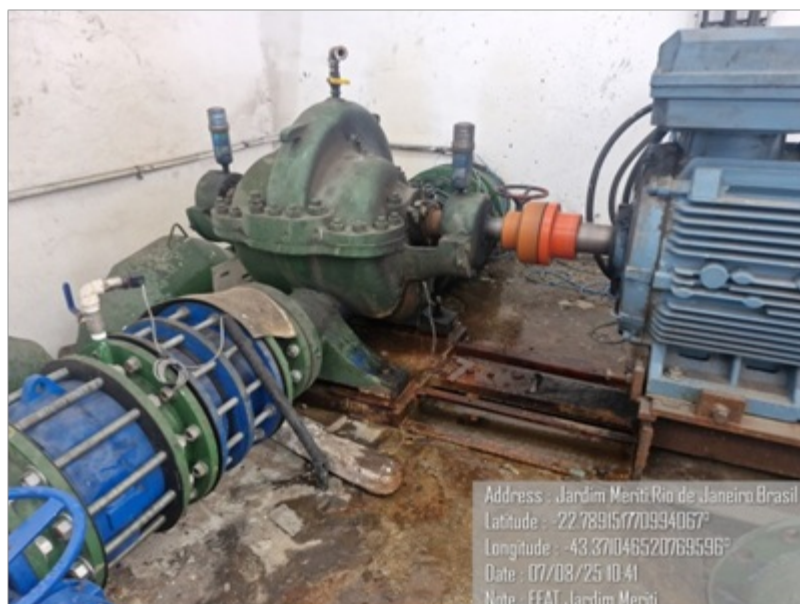
Foto 4 – Barrilete do booster e conjuntos motobombas
