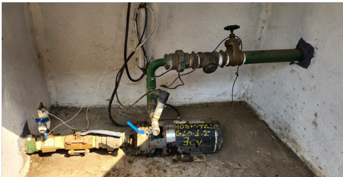
Foto 4 – Tubulação de retaguarda e recalque
