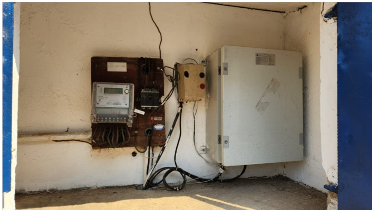
Foto 5 – Fiação elétrica não protegida
