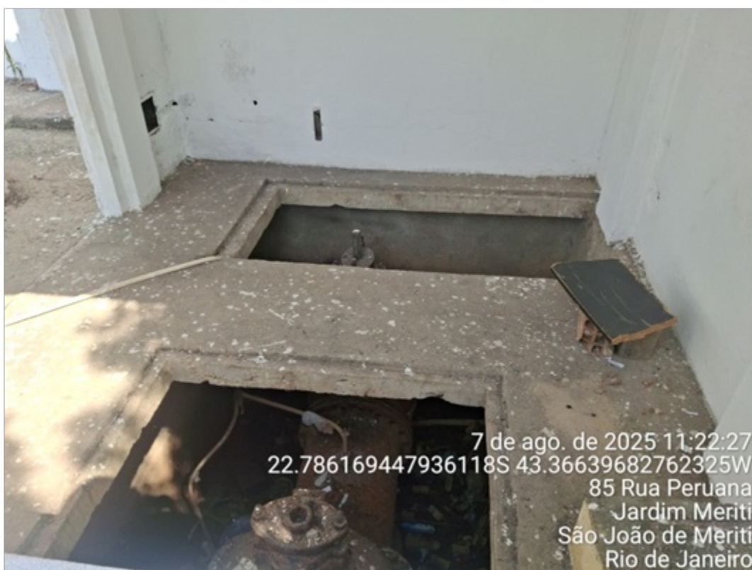
Foto10: Barrilete sem tampa
