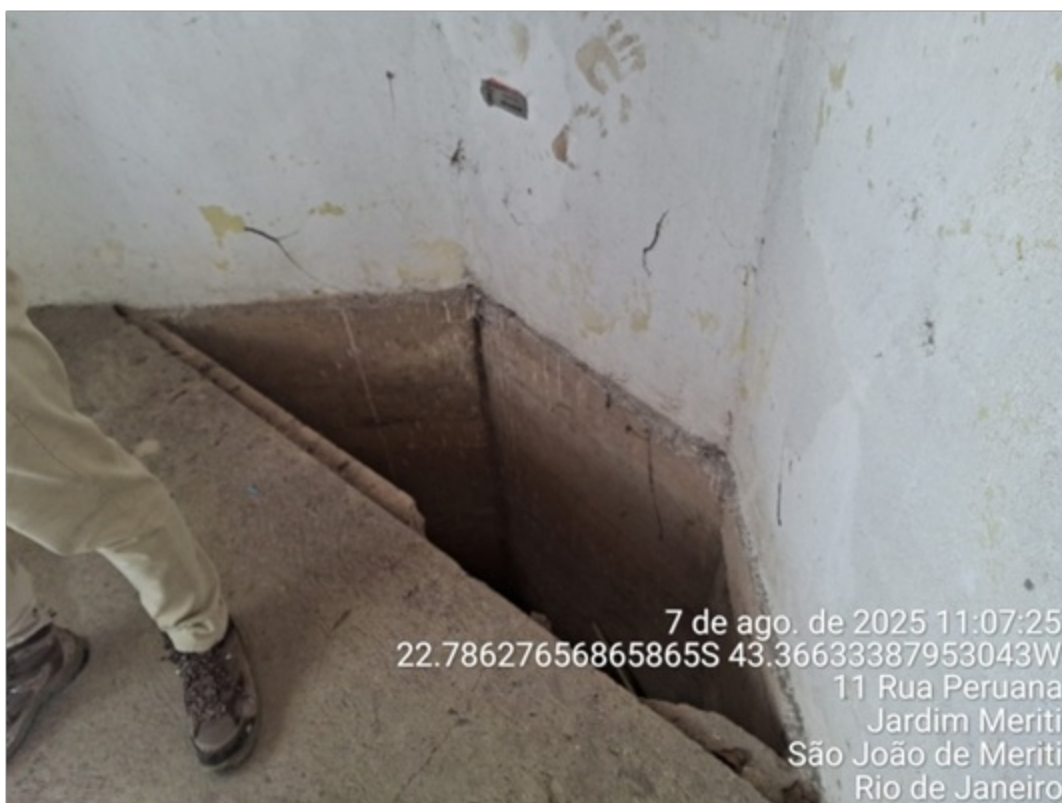
Foto 9: Trecho barrilete sem tampa
