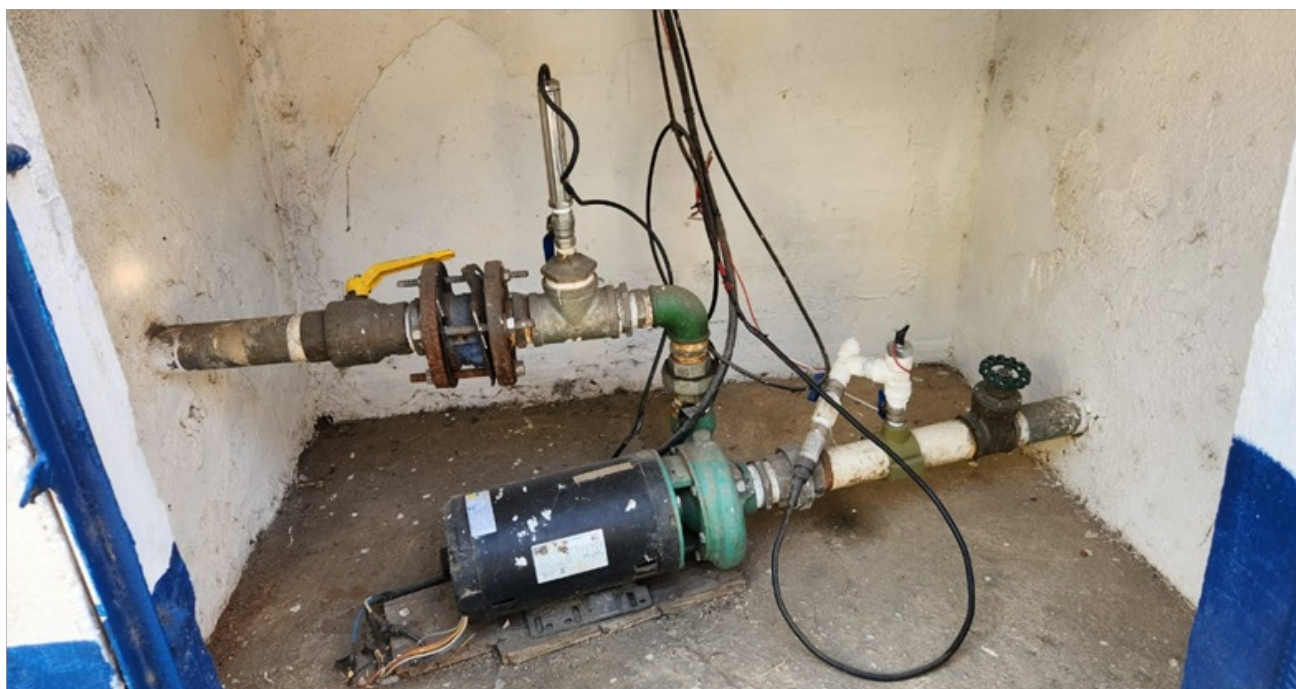
Foto 4 – Tubulação de retaguarda e recalque
