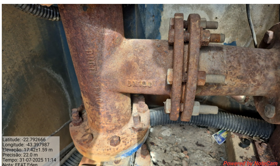
Foto 4. Estrutura do conjunto motobomba com oxidação.
