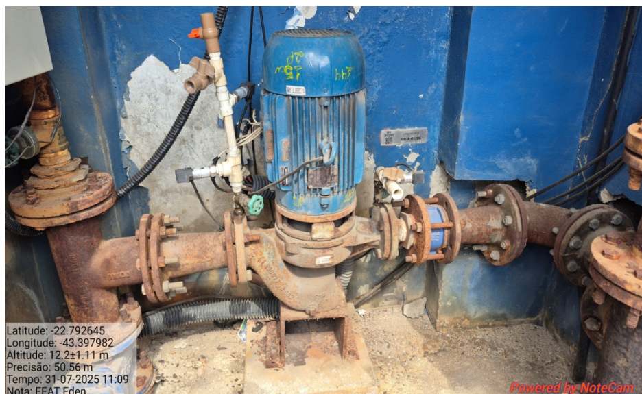
Foto 3. Conjunto motobomba da unidade com oxidação e fios remendados.
