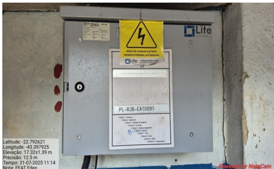
Foto 5. Pannel da estação com sinalização de risco de choque elétrico.
