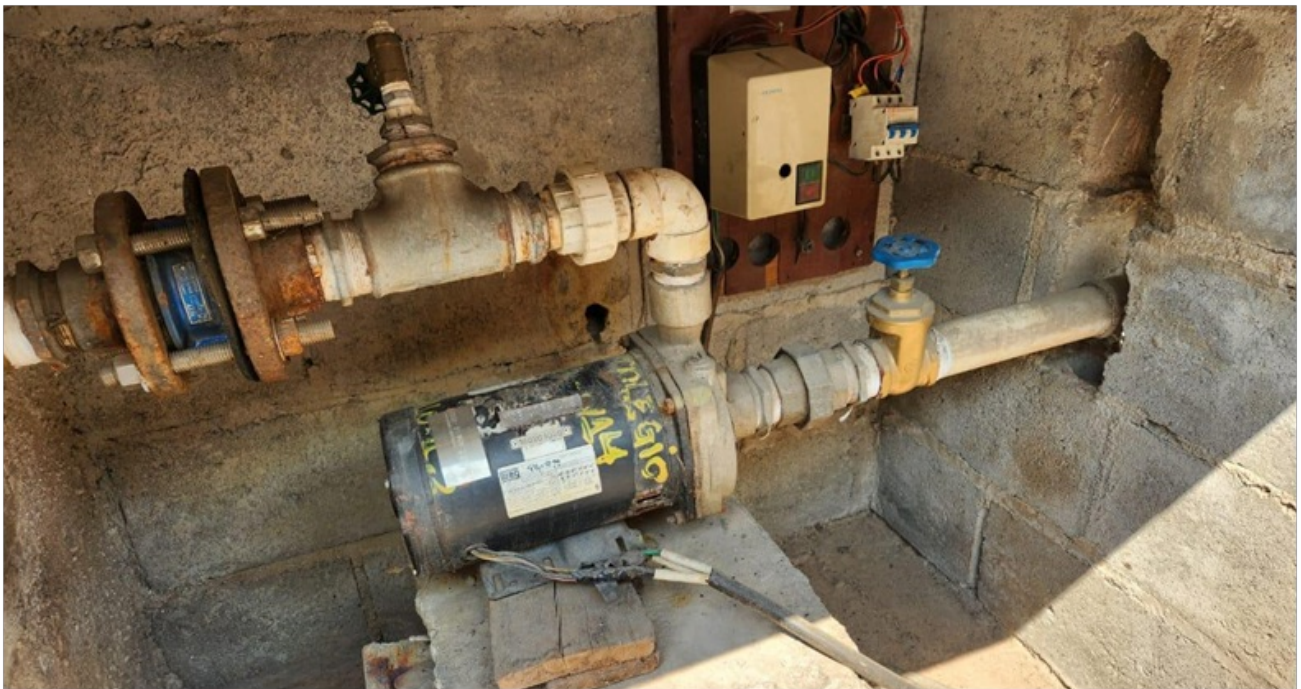
Foto 4 – Tubulação de retaguarda e recalque
