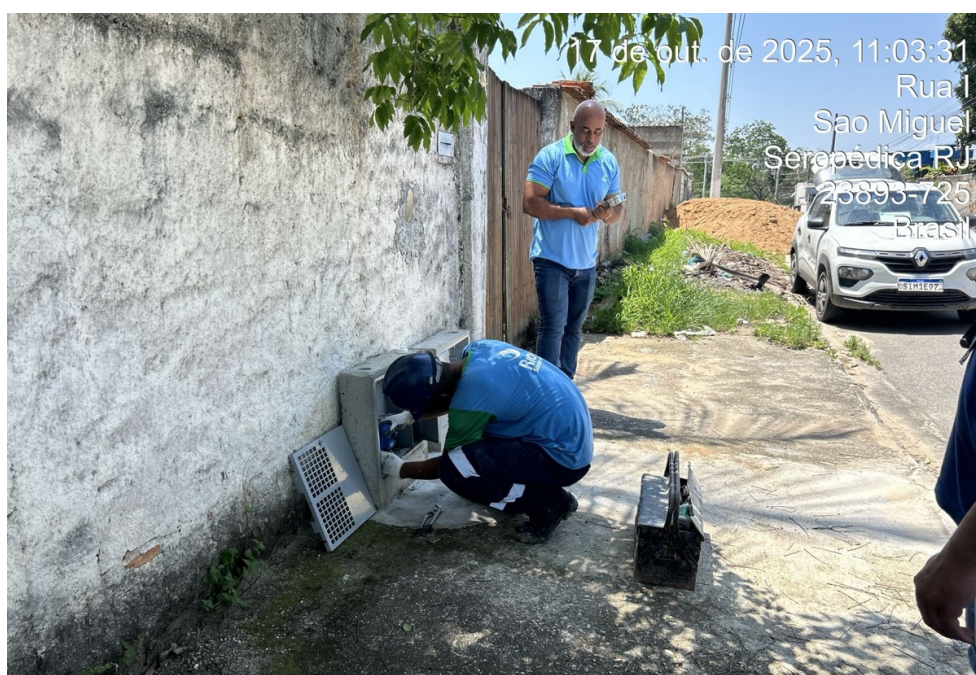
Fotos 2 – Hidrômetros existentes no local
