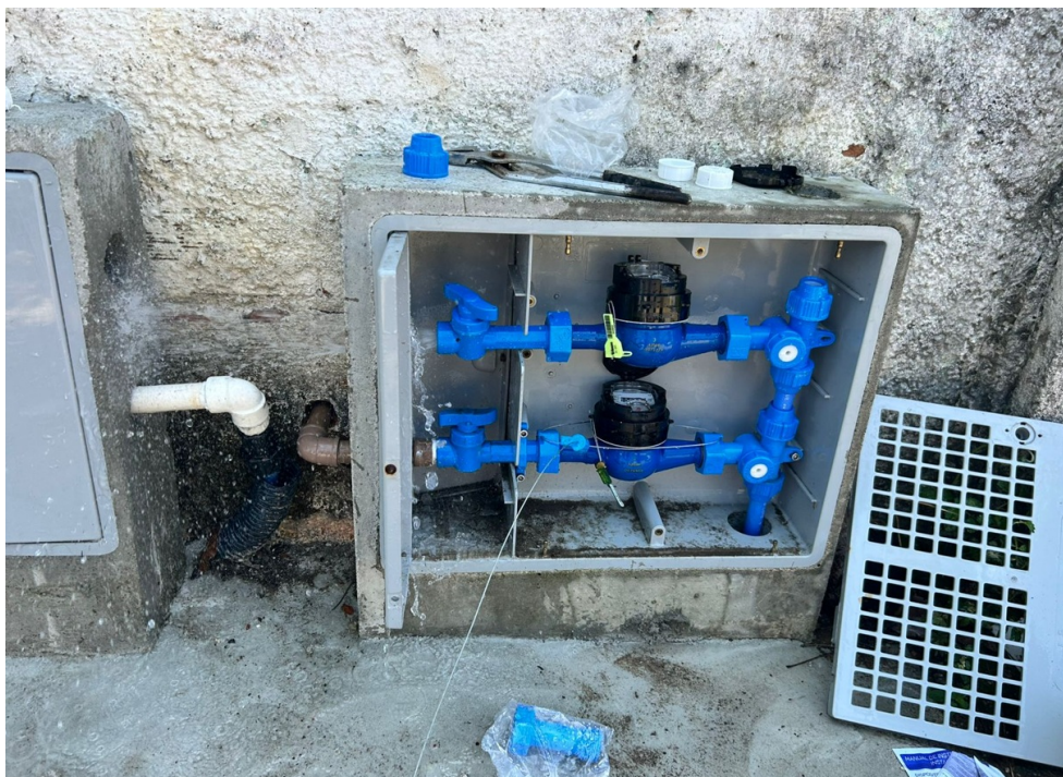
Foto 5 – Hidrômetro instalado para o imóvel da usuária
