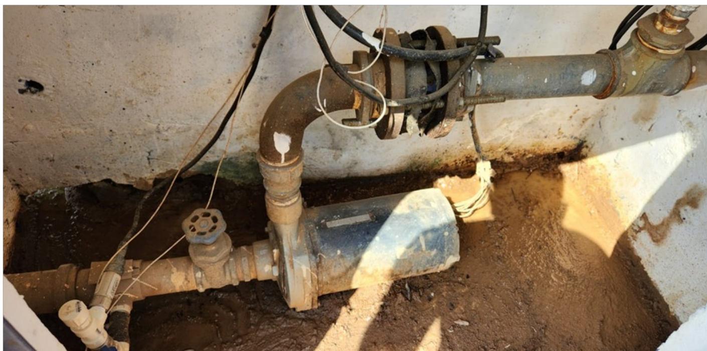
Foto 5 – Tubulação de retaguarda e recalque
