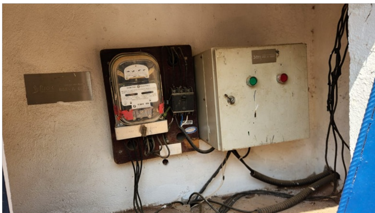
Foto 6 – Fiação elétrica não protegida
