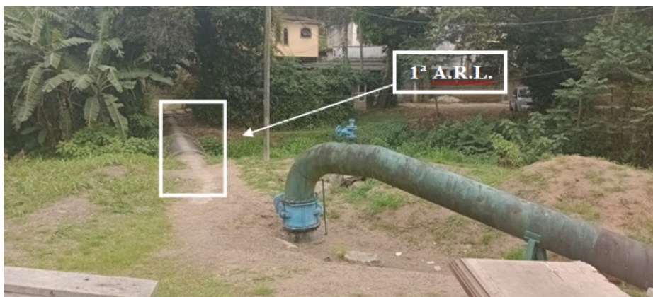
Foto 2 – Alça hidráulica (tubulação DN 500 mm) que sai da 1ª Adutora de Ribeirão das Lajes (1ª A.R.L.)
