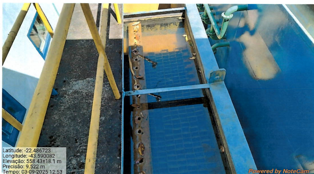
Foto 15: ETA Nova - decantador.
