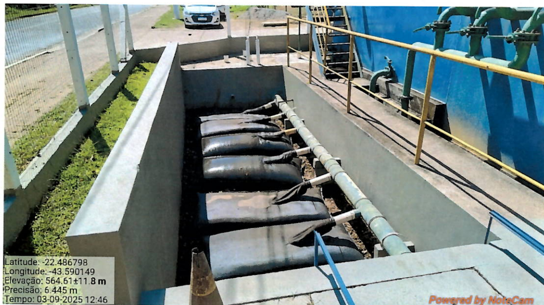
Foto 18: sistema de tratamento de lodos.
