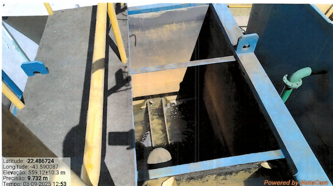
Foto 16: ETA Nova - filtros.
