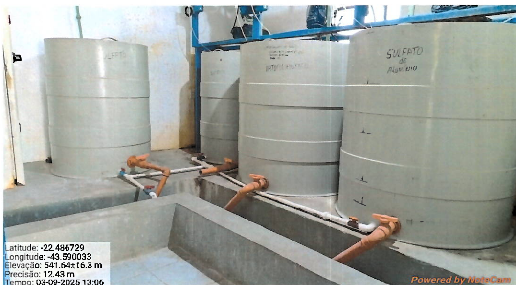
Foto 24: Armazenamento de sulfato de alumínio (sem bacia de contenção).
