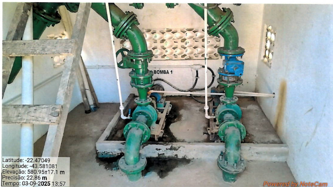
Foto 4: EEAB – duas bombas de 3cv em operação.
