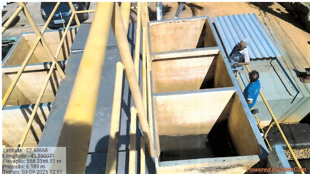
Foto 12: ETA Nova - filtros.
