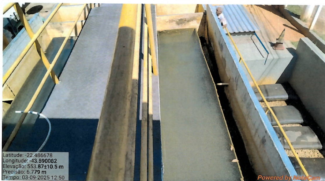
Foto 11: ETA Nova - decantador.
