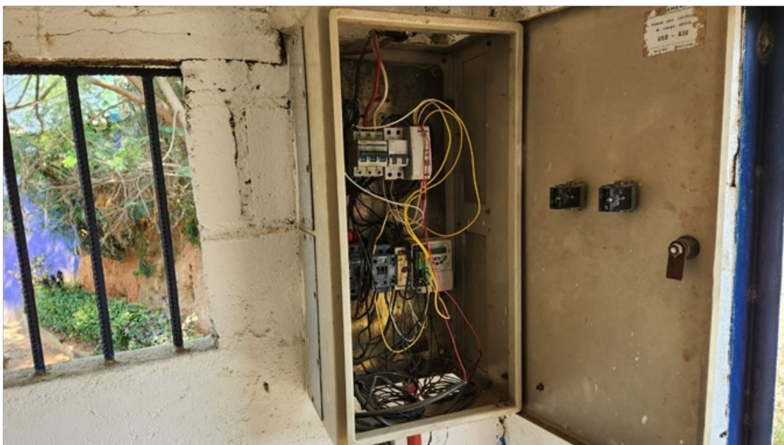
Foto 8 – Pannel de automação da elevatória
