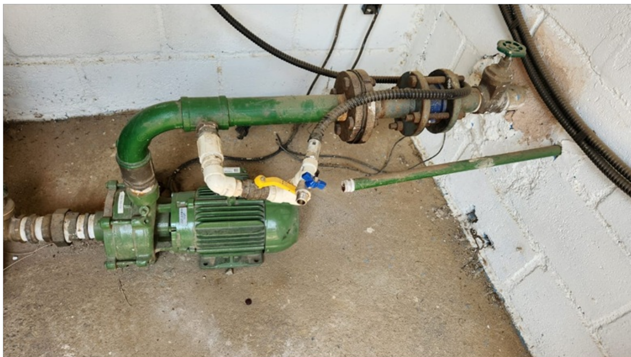
Foto 5 – Tubulação de retaguarda e recalque
