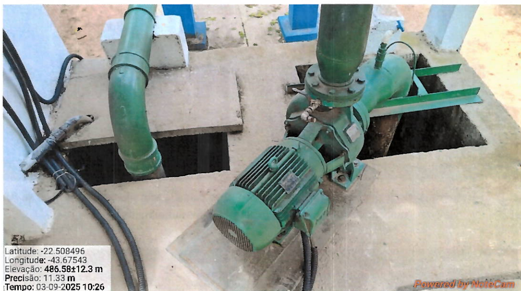
Foto 3: Conjunto motobomba em operação.
