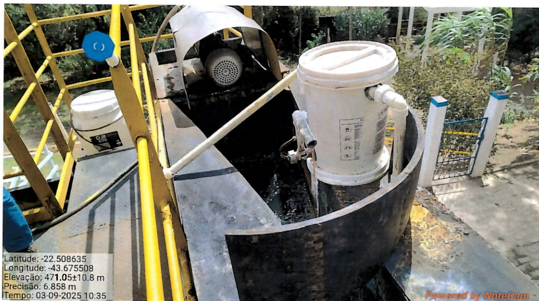
Foto 7: Entrada de água bruta na ETA com aplicação de coagulante sulfato de alumínio.
