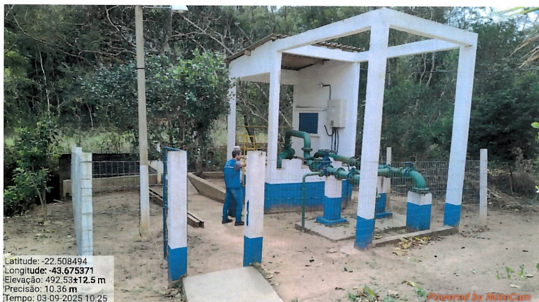
Foto 1: Entrada para o ponto de captação e EEAB (área cercada sem placa de identificação de manancial com indicação de uso para consumo humano).
