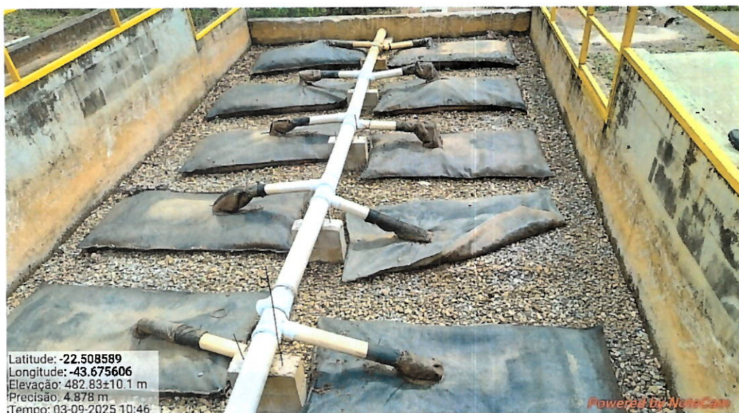
Foto 13: sistema de tratamento de lodo inoperante.
