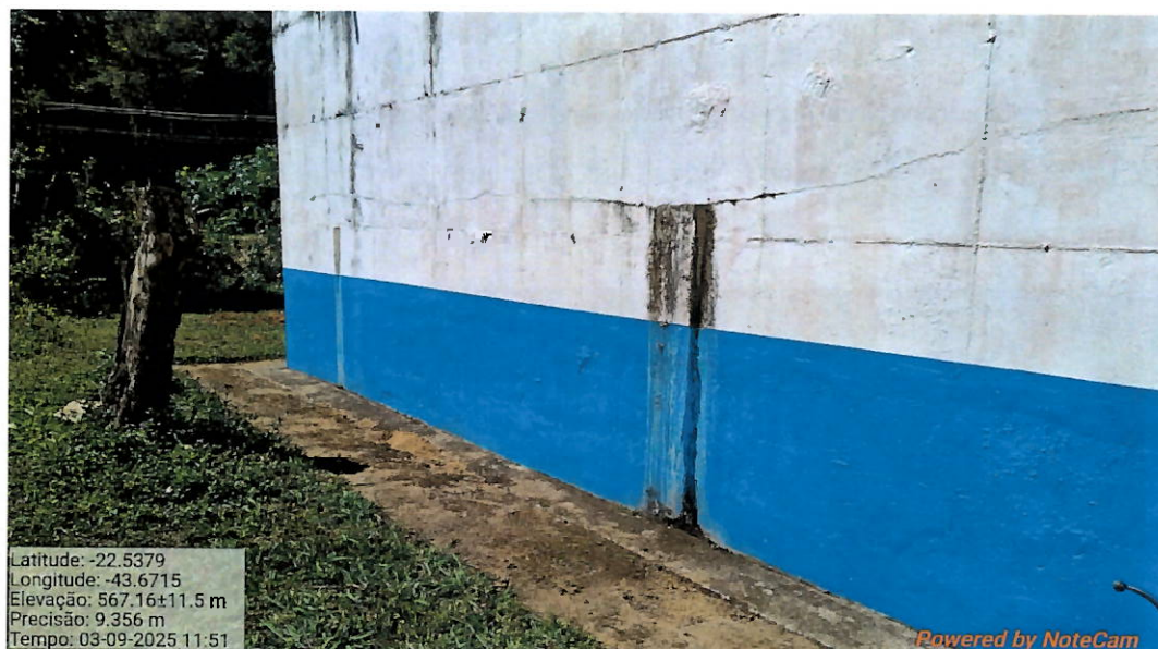
Foto 23: ponto de infiltração
