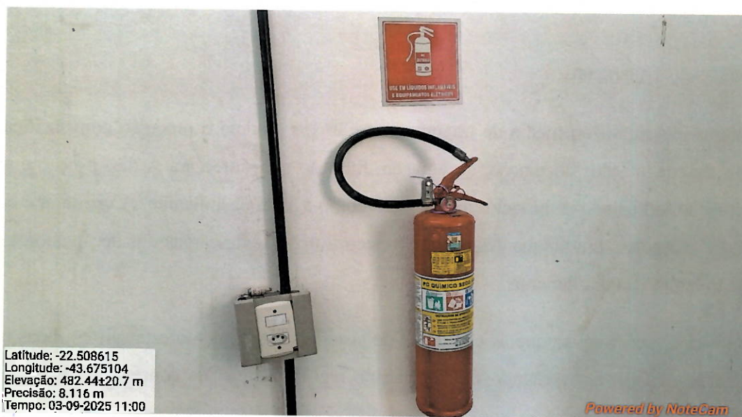
Foto 5: Extintor de incêndio
