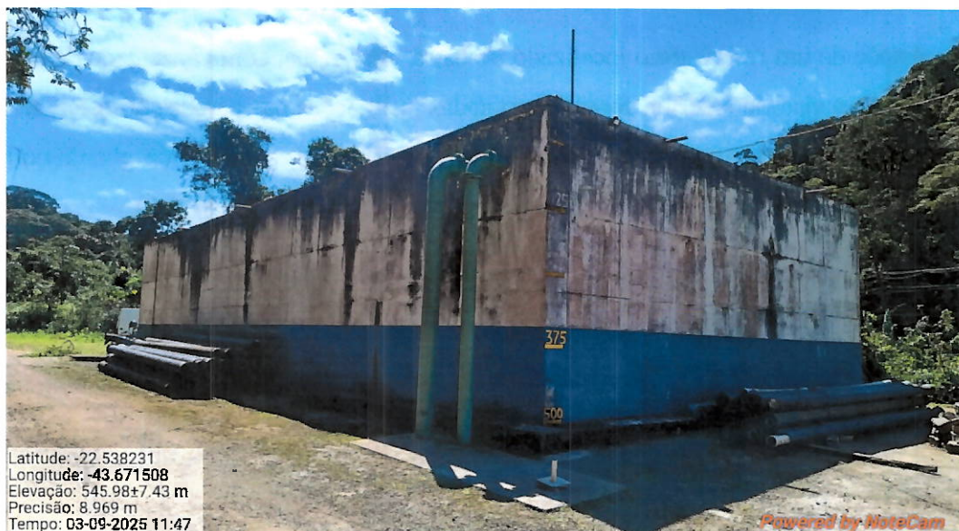
Foto 22: Reservatório (ausência de escada com gaiola de proteção, guarda-corpo e SPDA).
