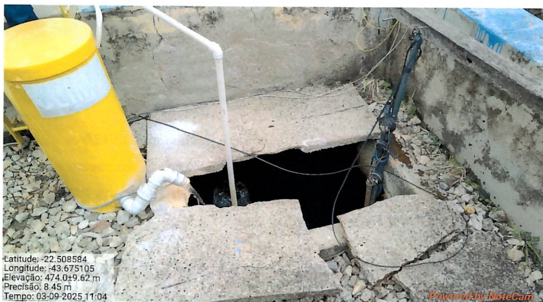
Foto 12: Ausência de tampa estanque sobre o tanque de contato.
