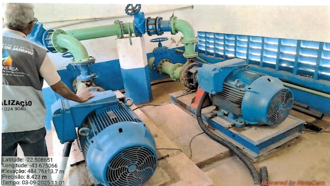
Foto 14: Conjuntos motobombas de potência 125 cv cada.
