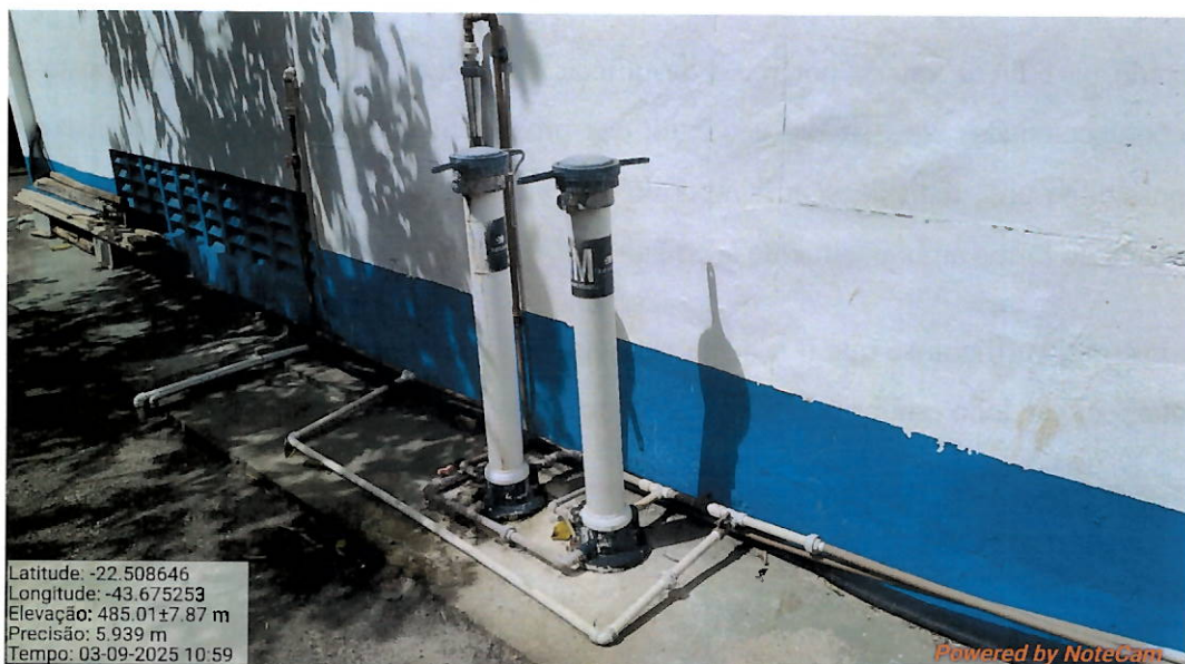
Foto 11: Sistema de cloração.
