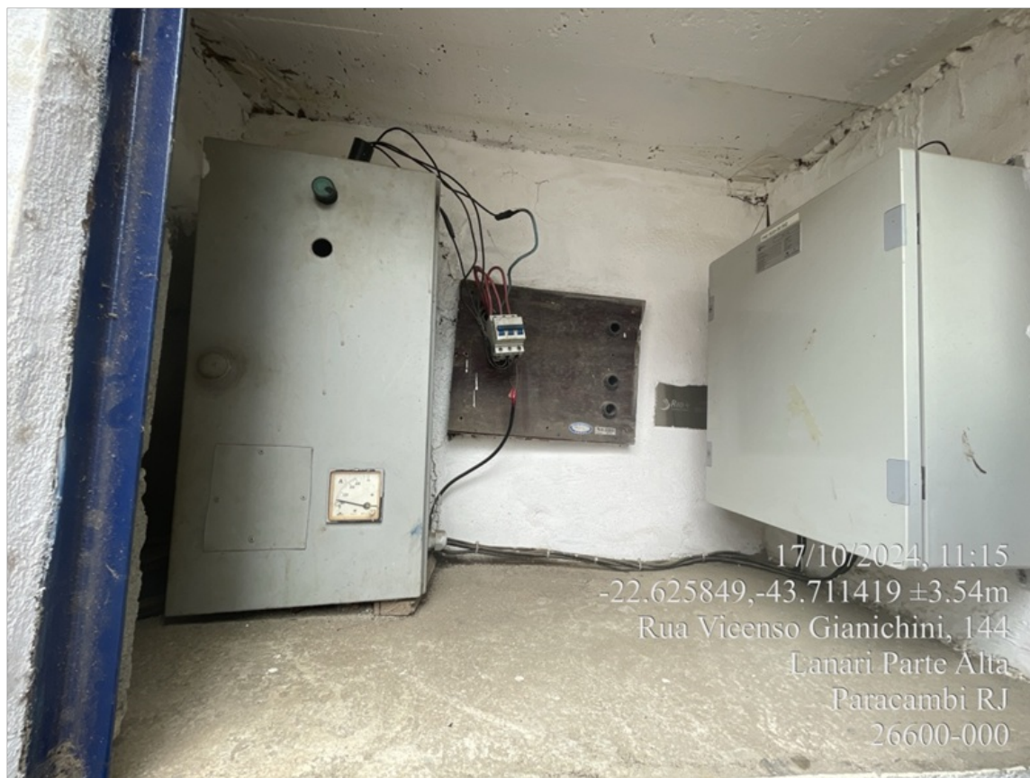
Foto 5 – Painéis de automação (com fiação exposta) e elétrico
