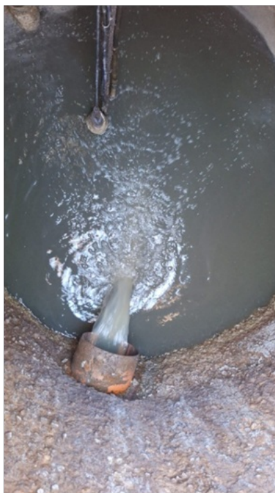
Foto 5 – Poço da EEE Dinossauro
